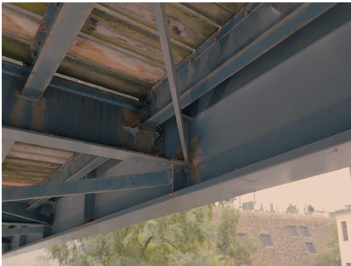
Obr.27 Pohled na korozní poškození a odlupování nátěru na příčniku a stěně lávky, pravá strana
