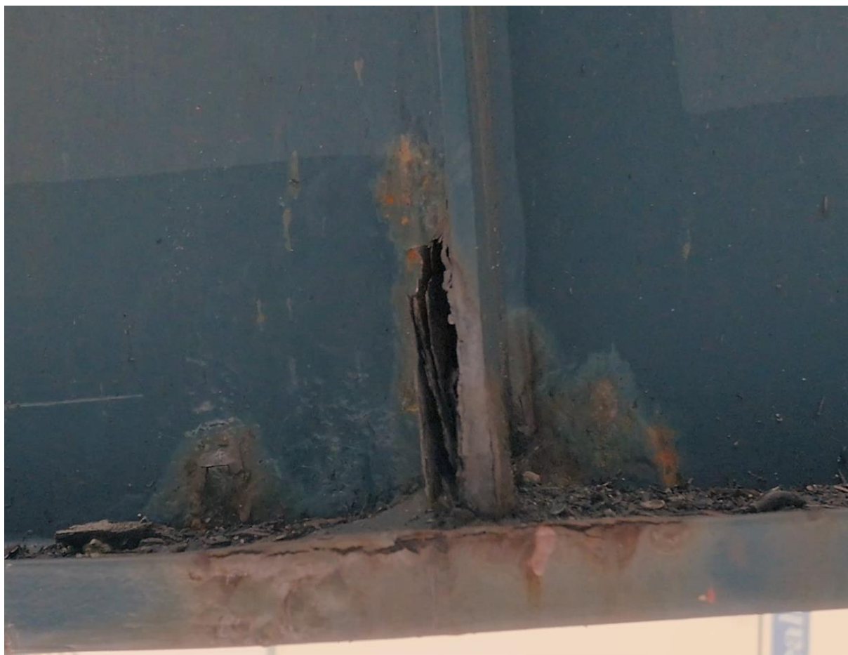
Obr.29 Korozní poškození a rozpad výztuhy stěny
