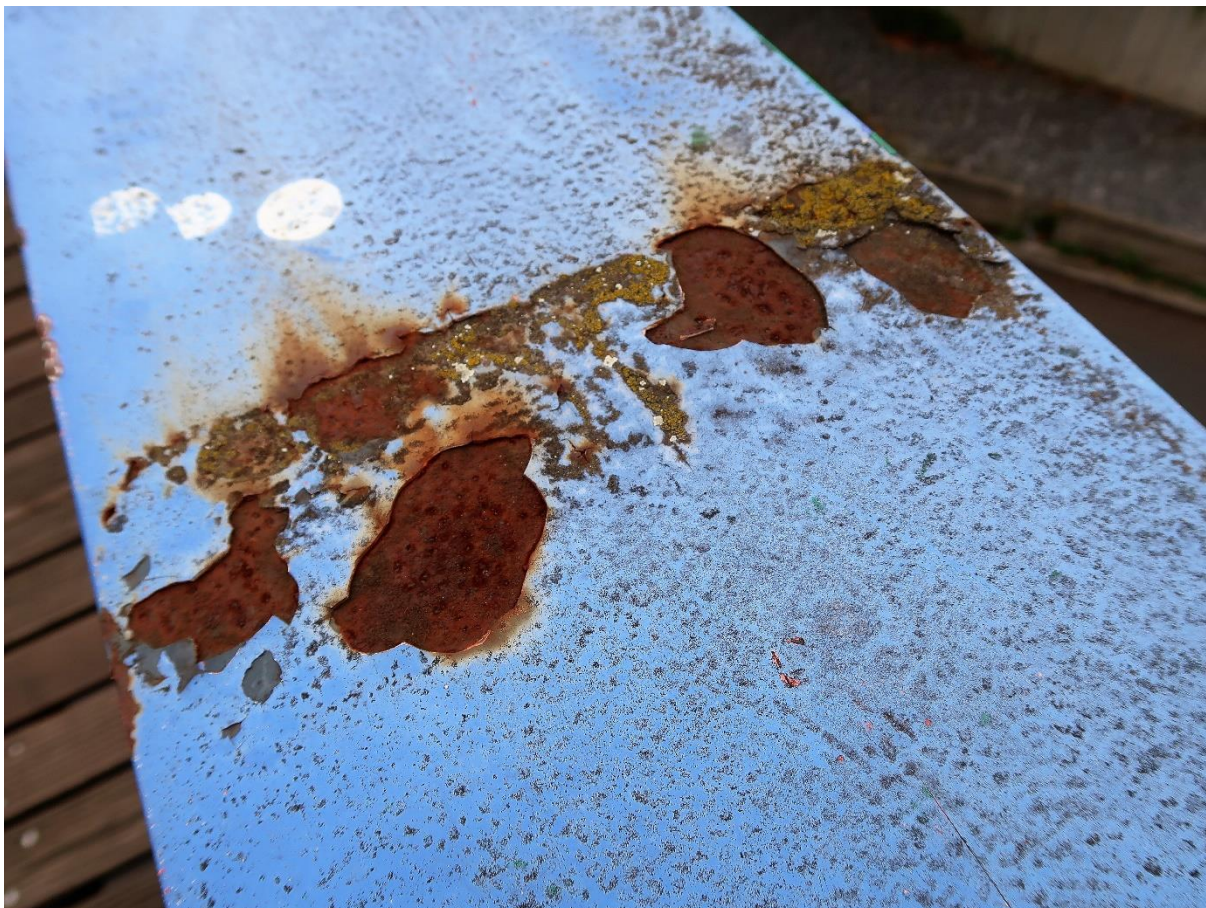
Obr.45 Odlupování nátěru horní pásnice a důlková koroze
