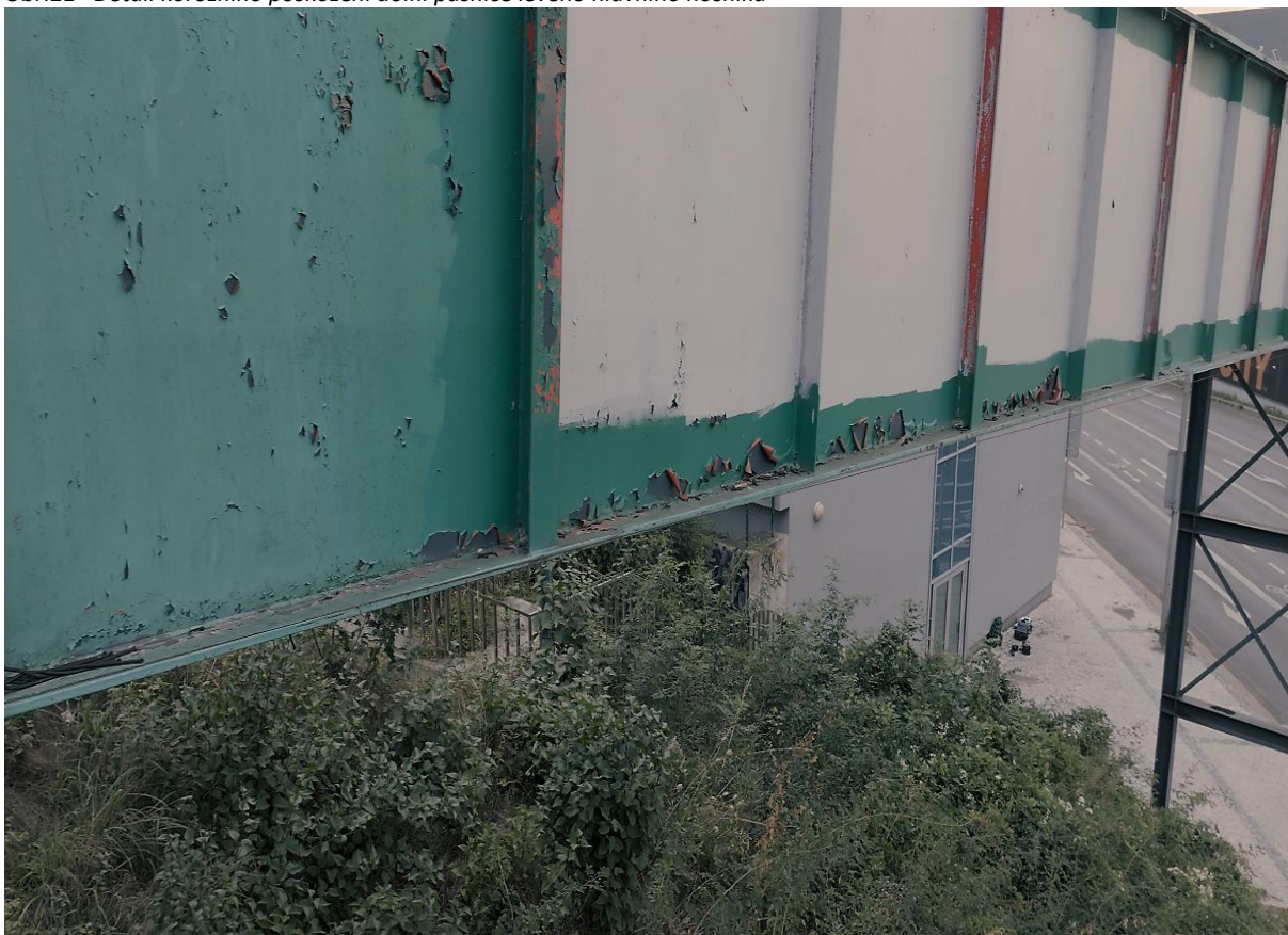
Obr.22 Pohled na odlupování nátěrového povlaku pravého hlavního nosníku v místě u parku
