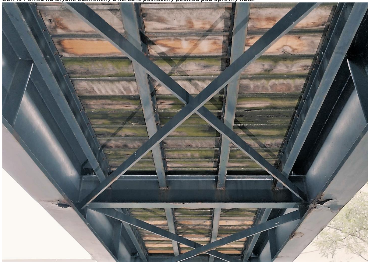
Obr.50 Pohled z dolní strany na odlupování nátěru dolních pásnic ve shodných místech (vada z výstavby)
