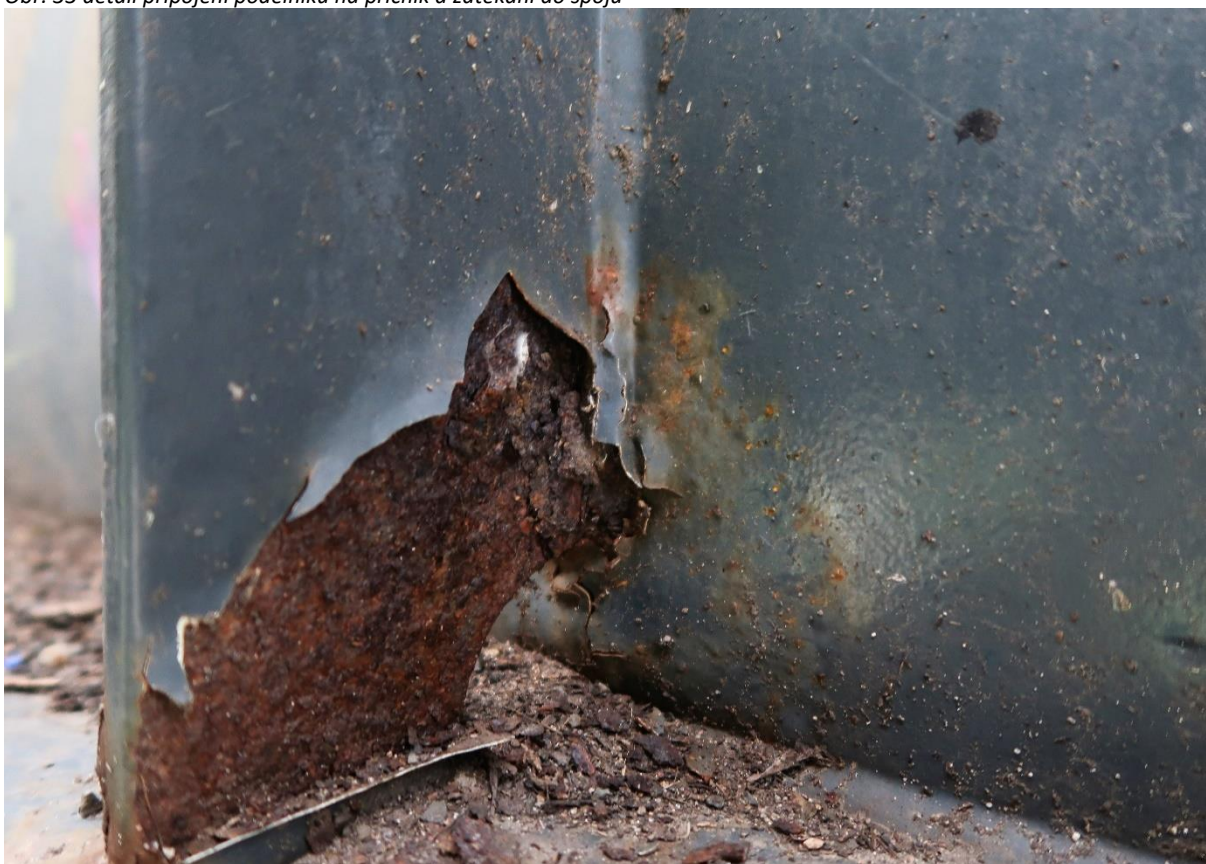
Obr.34 Korozní poškození svarů výztuhy stěny levý nosník z vnitřní strany, park
