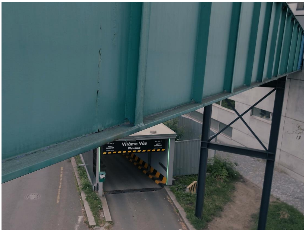
Obr.19 Pohled na korozní poškození stěny pravého hlavního nosníku
