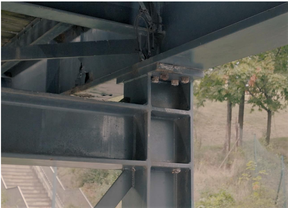
Obr.59 Pohled na uložení lávky na druhé podpěře, první pilíř, vlevo, krátké šrouby, otevřený styk, korozní poškození
