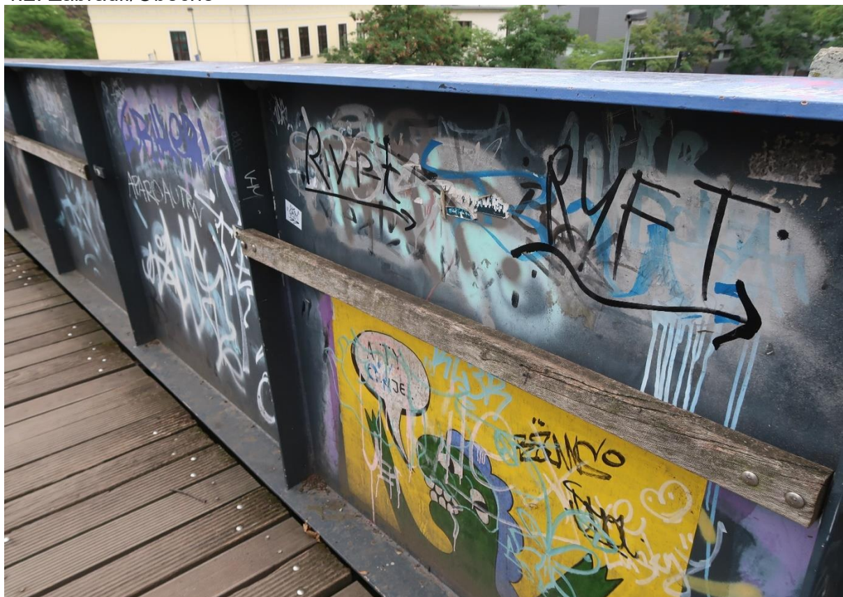
Obr.75 Pohled na chybějící madla zábradlí
