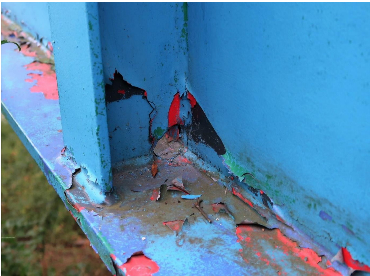
Obr.37 Odlupování vrstev nátěru na levé straně hlavního nosníku, park
