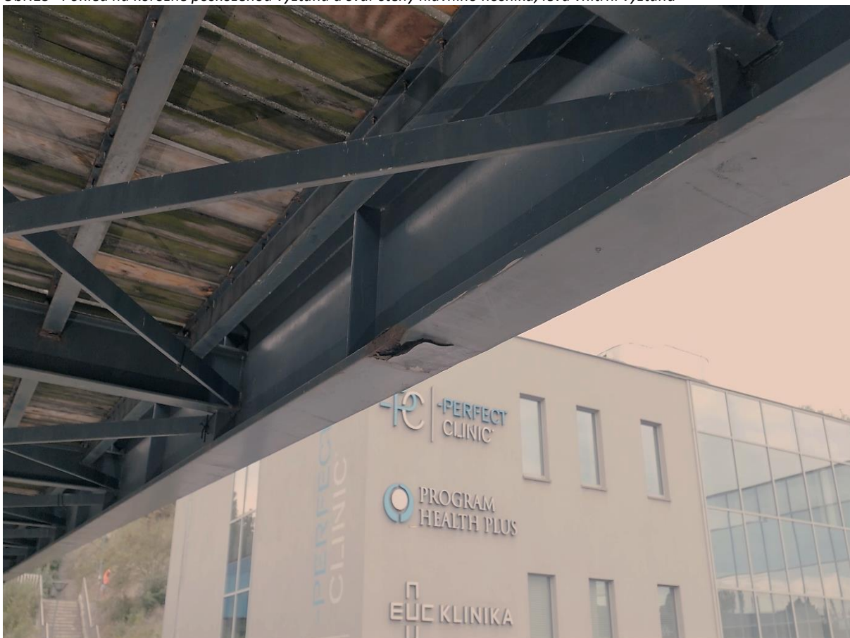
Obr.16 Pohled na dolní pásnici levého hlavního nosníku s korozním poškozením
