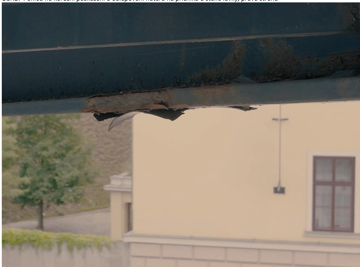
Obr.28 detail korozního poškození dolní pásnice
