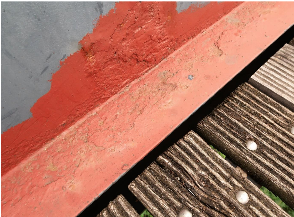
Obr.39 Pohled na chybně odstraněný a korozně poškozený podklad pod opravný nátěr
