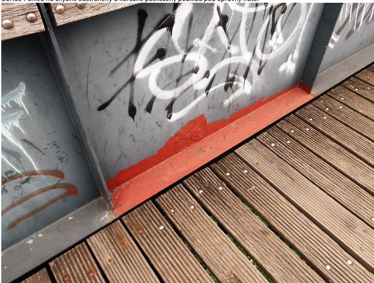
Obr.40 Pohled na chybně odstraněný a korozně poškozený podklad pod opravný nátěr
