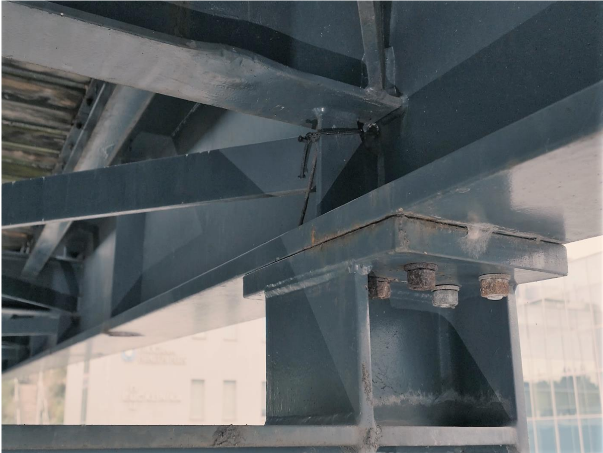
Obr.63 Pohled na uložení lávky na třetí podpěře, druhý piliř, vlevo, krátké šrouby, otevřený styk, korozní poškození a deformace příčnicku
