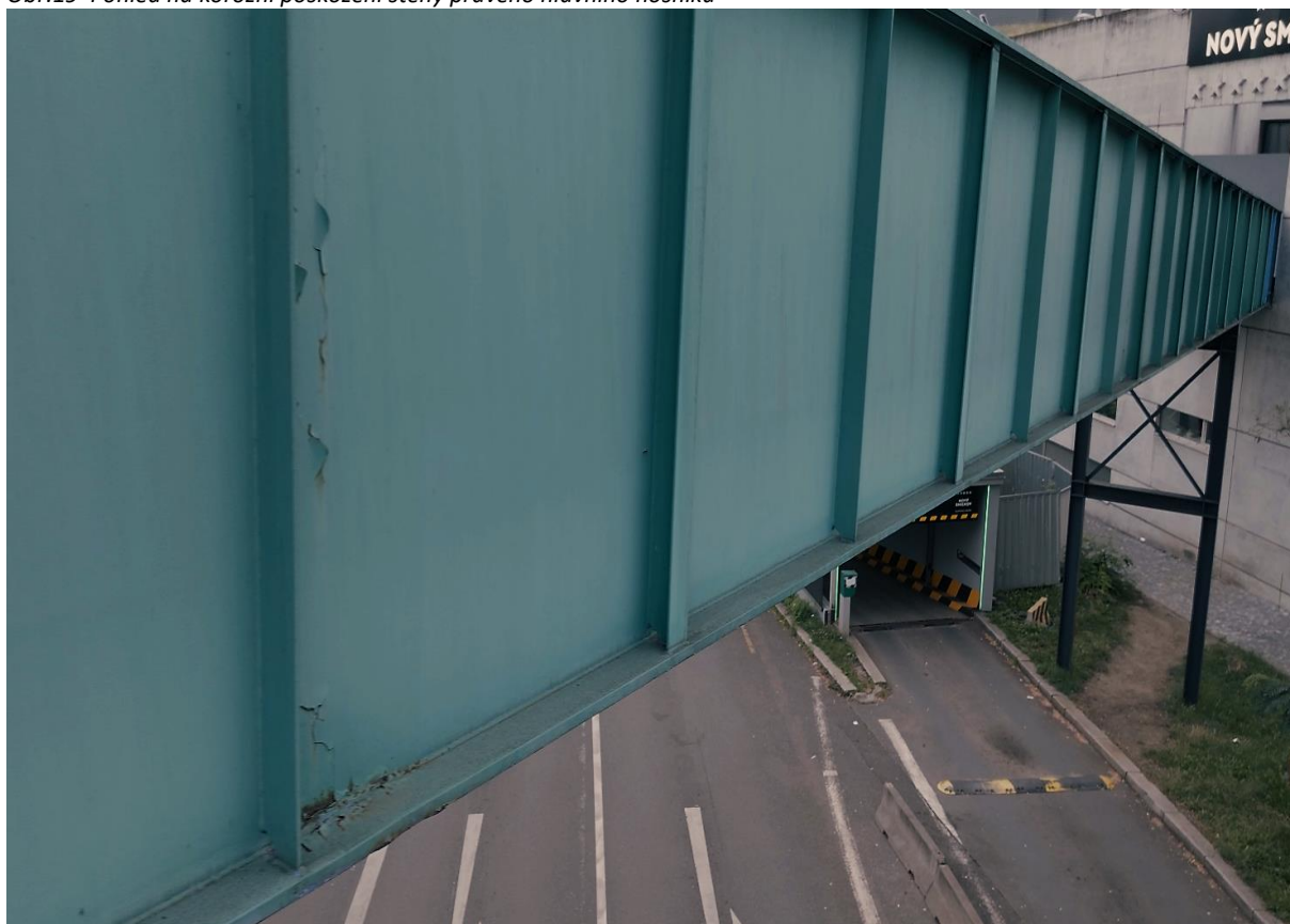
Obr.20 Pohled na korozní poškození stěny pravého hlavního nosníku
