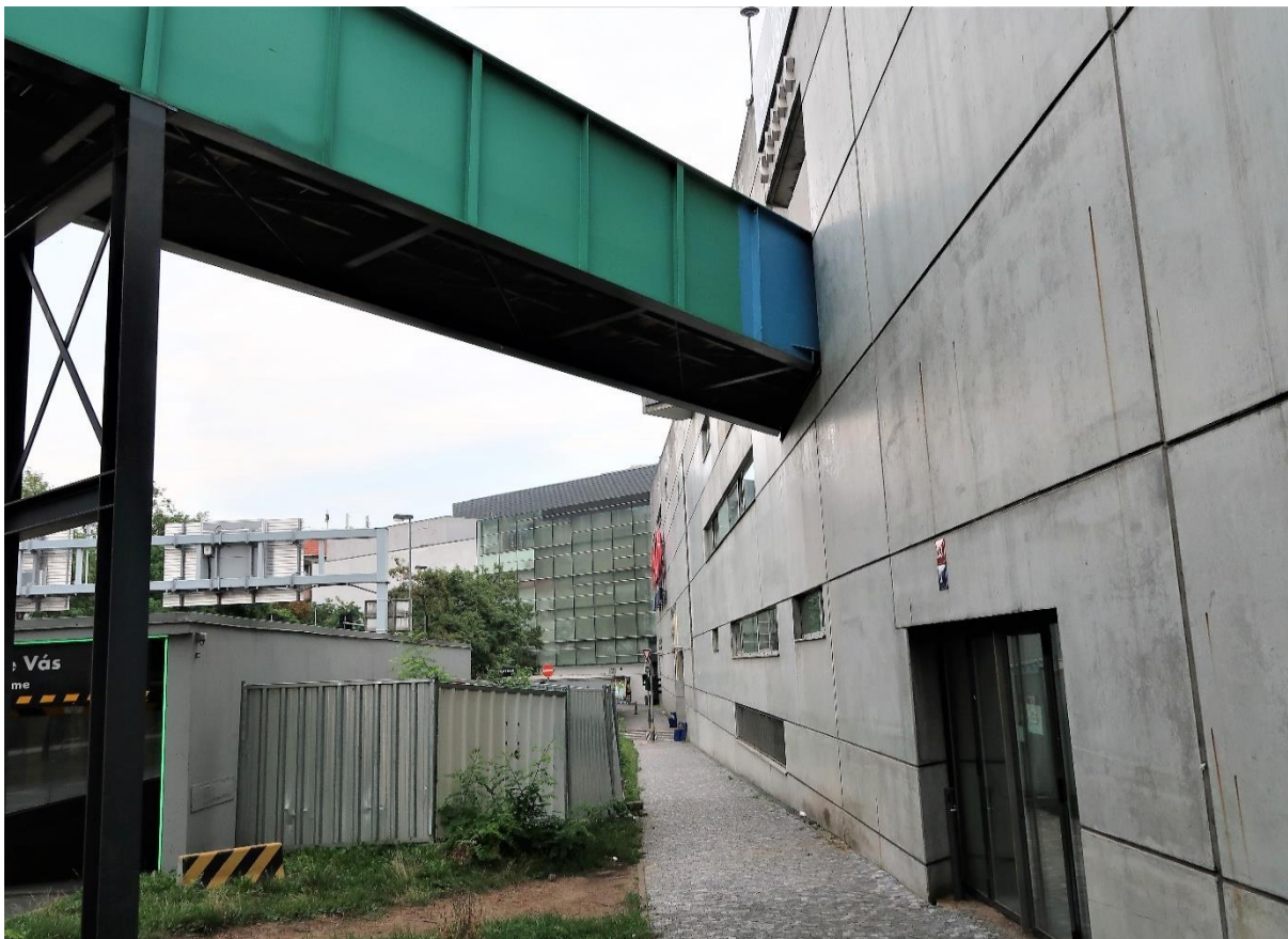
Obr.5 Pohled na kombinace nátěrových povlaků na pravě straně nosné konstrukce
