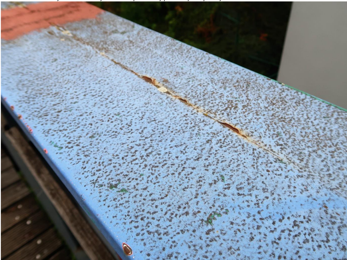
Obr.44 Korozní poškození horní pásnice pravděpodobně pojezdem lávky pro nátěr
