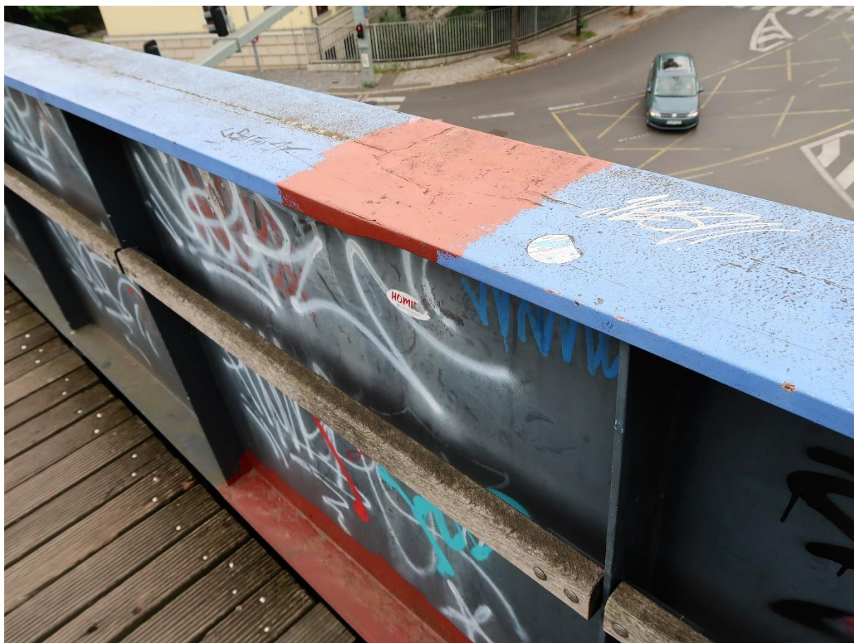
Obr.41 Pohled na chybně odstraněný a korozně poškozený podklad pod opravný nátěr
