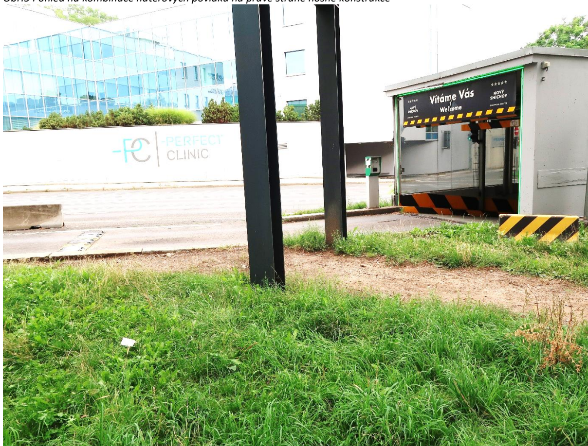
Obr.6 Pohled na korozní poškození druhého pilíře u vegetace
