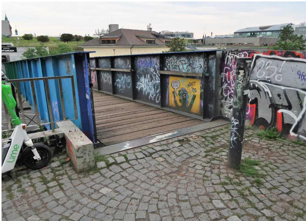
Obr.77 Pohled na chybějící madla zábradlí
