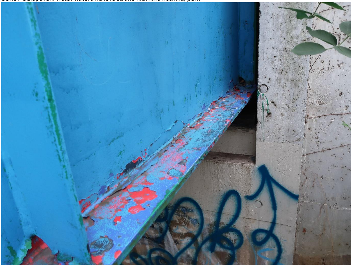
Obr.38 Odlupování vrstev nátěru levý nosník, uložení park
