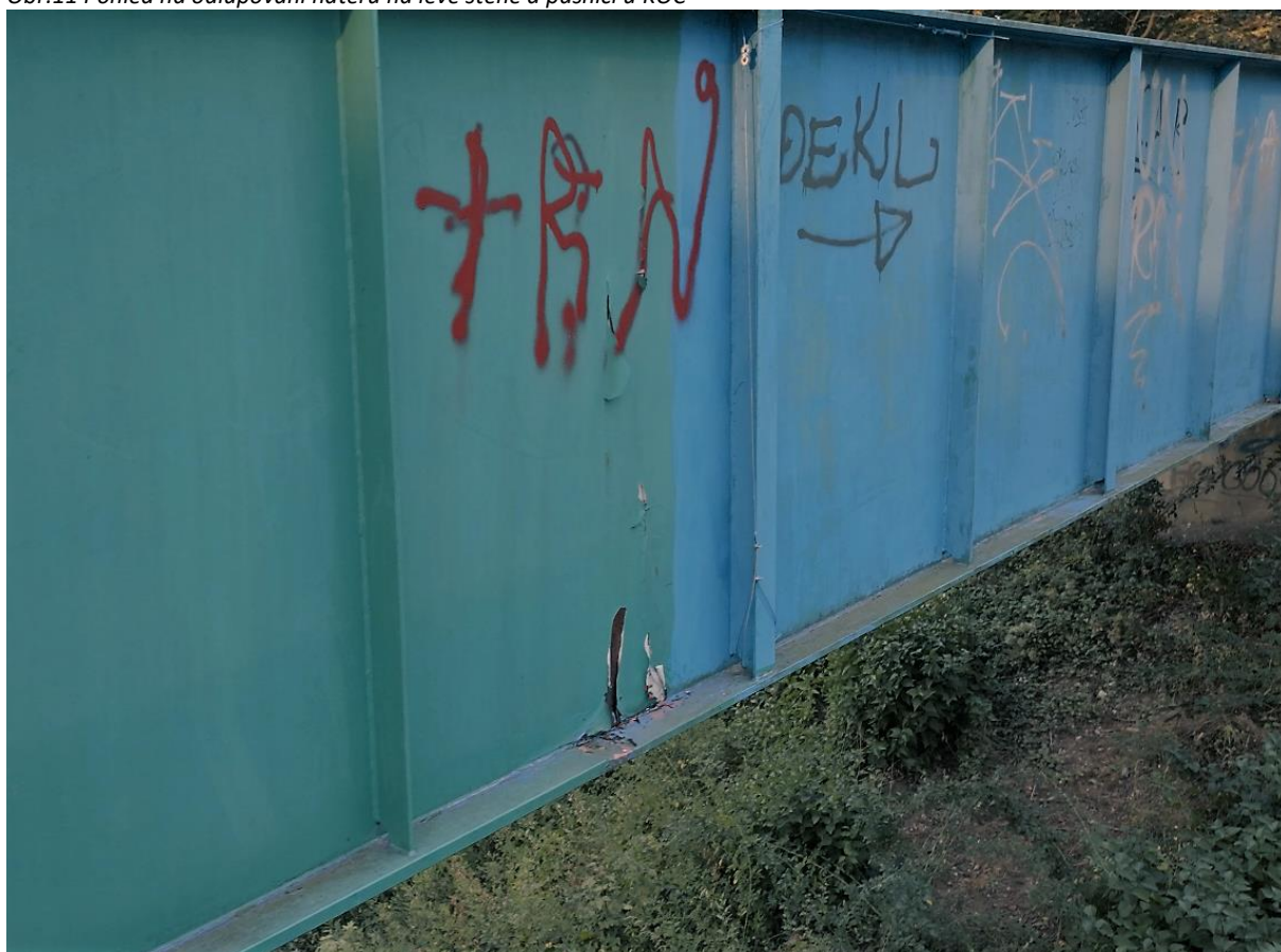
Obr.12 Pohled na mechanické poškození nátěru na podklad a korozní poškození stěny, levá strana od parku
