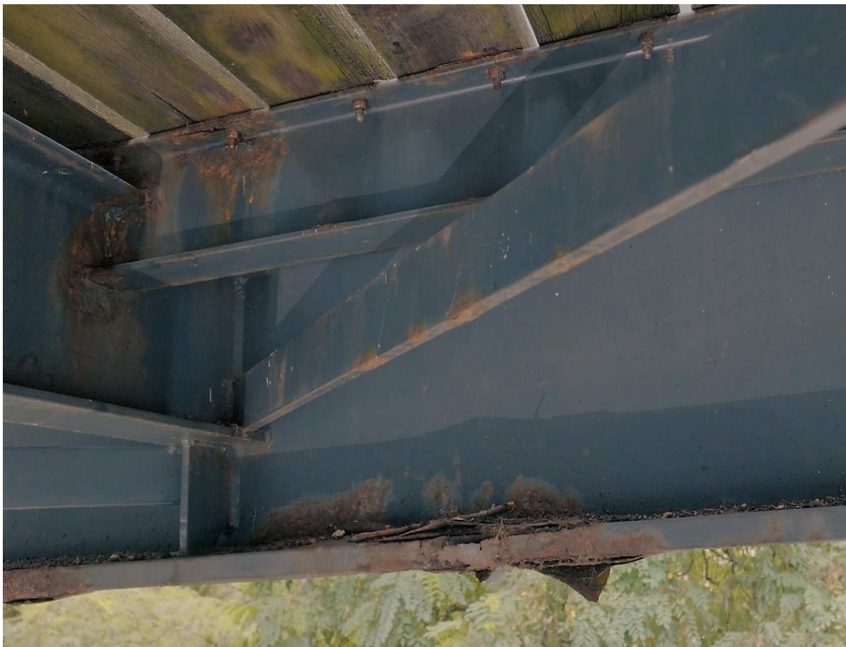
Obr.31 Korozní poškození ve vrstvách dolní pásnice pravá strana z vnitřní strany nosníku, včetně svarových spojů
