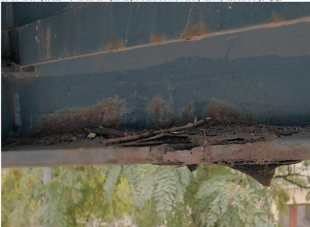
Obr.32 Detail korozního poškození ve vrstvách
