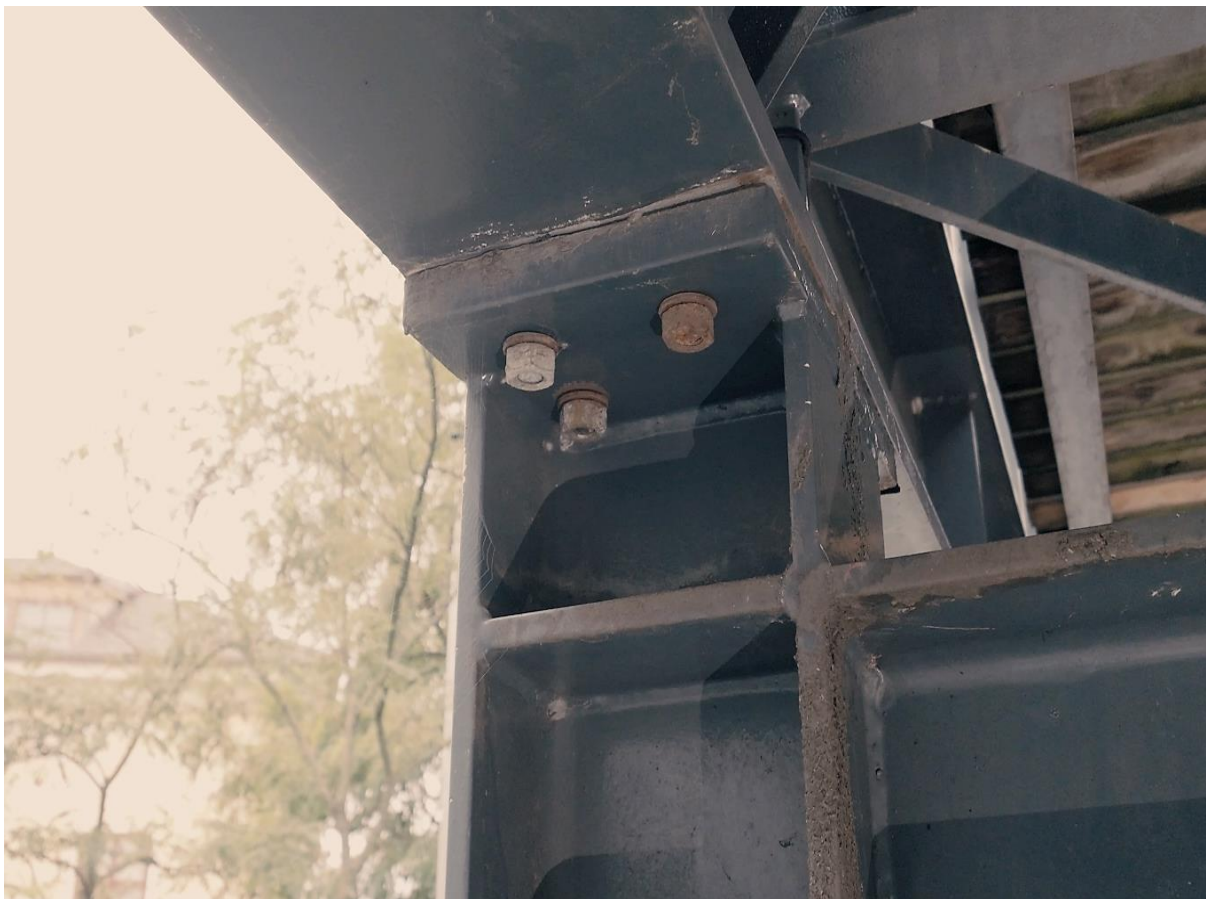
Obr.57 Pohled na uložení lávky na třetí podpěře, druhý pilíř, vpravo, krátké šrouby, otevřený styk, korozní poškození
