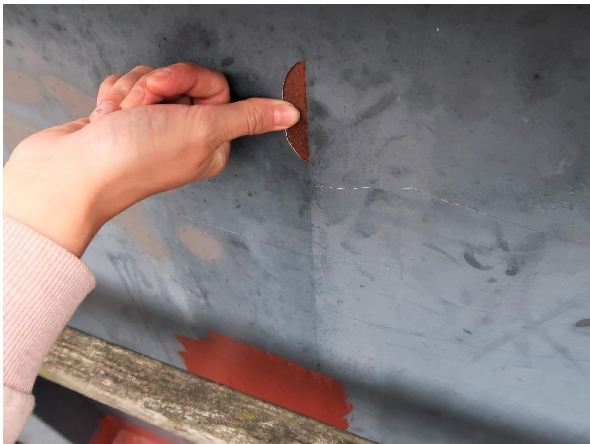
Obr.49 Pohled na chybně odstraněný a korozně poškozený podklad pod opravný nátěr
