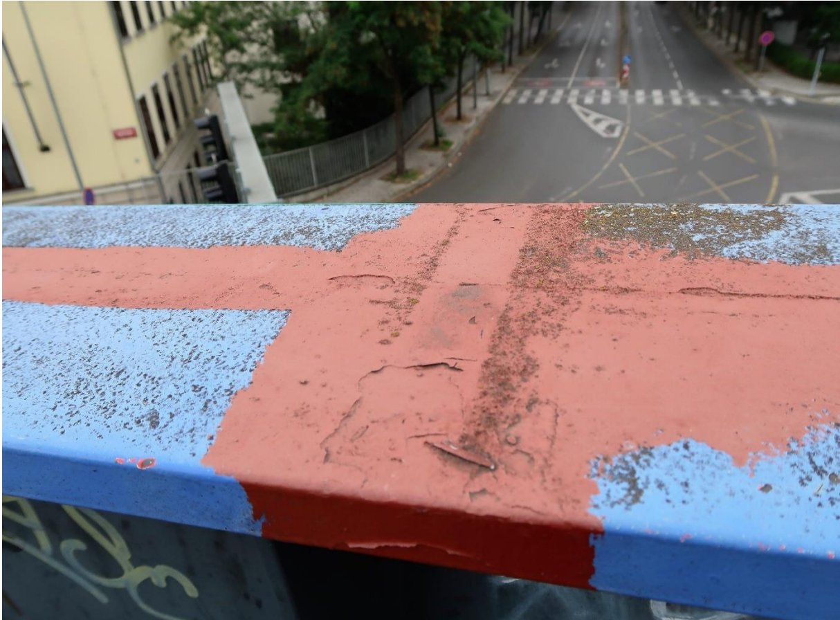
Obr.43 Pohled na chybně odstraněný a korozně poškozený podklad pod opravný nátěr
