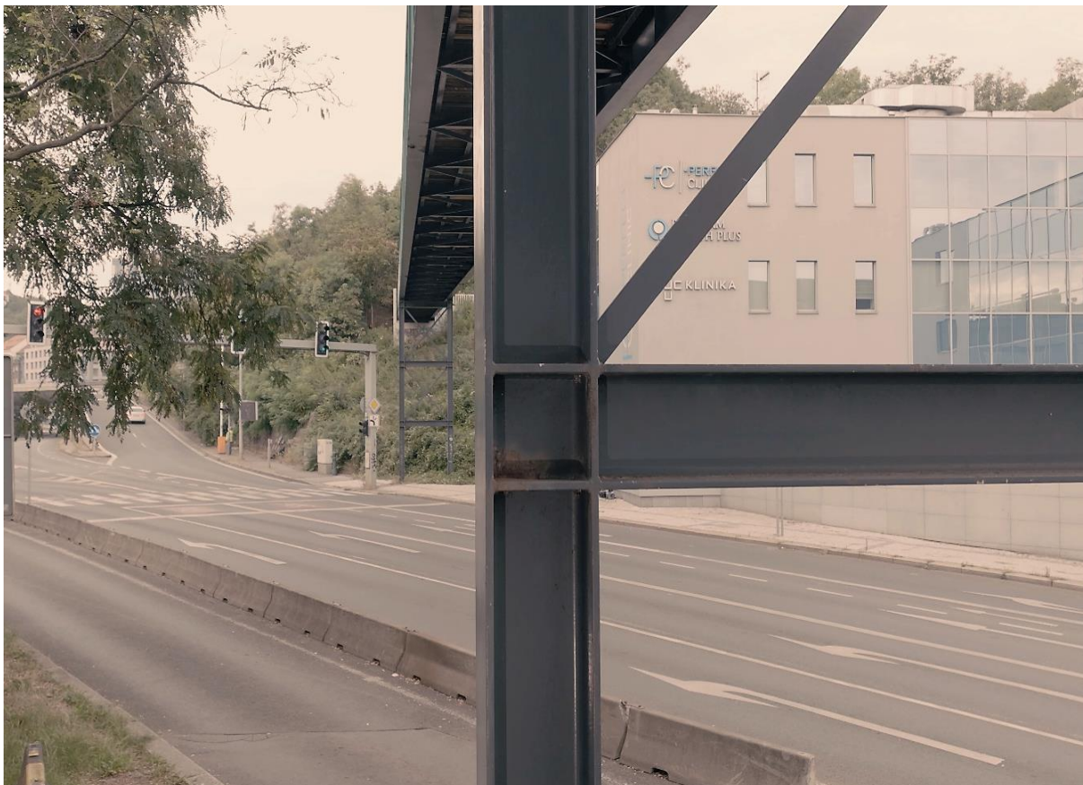
Obr.9 Pohled na detail korozního poškození druhého pilíře
