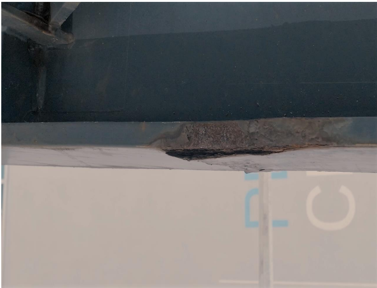
Obr.21 Detail korozního poškození dolní pásnice levého hlavního nosníku
