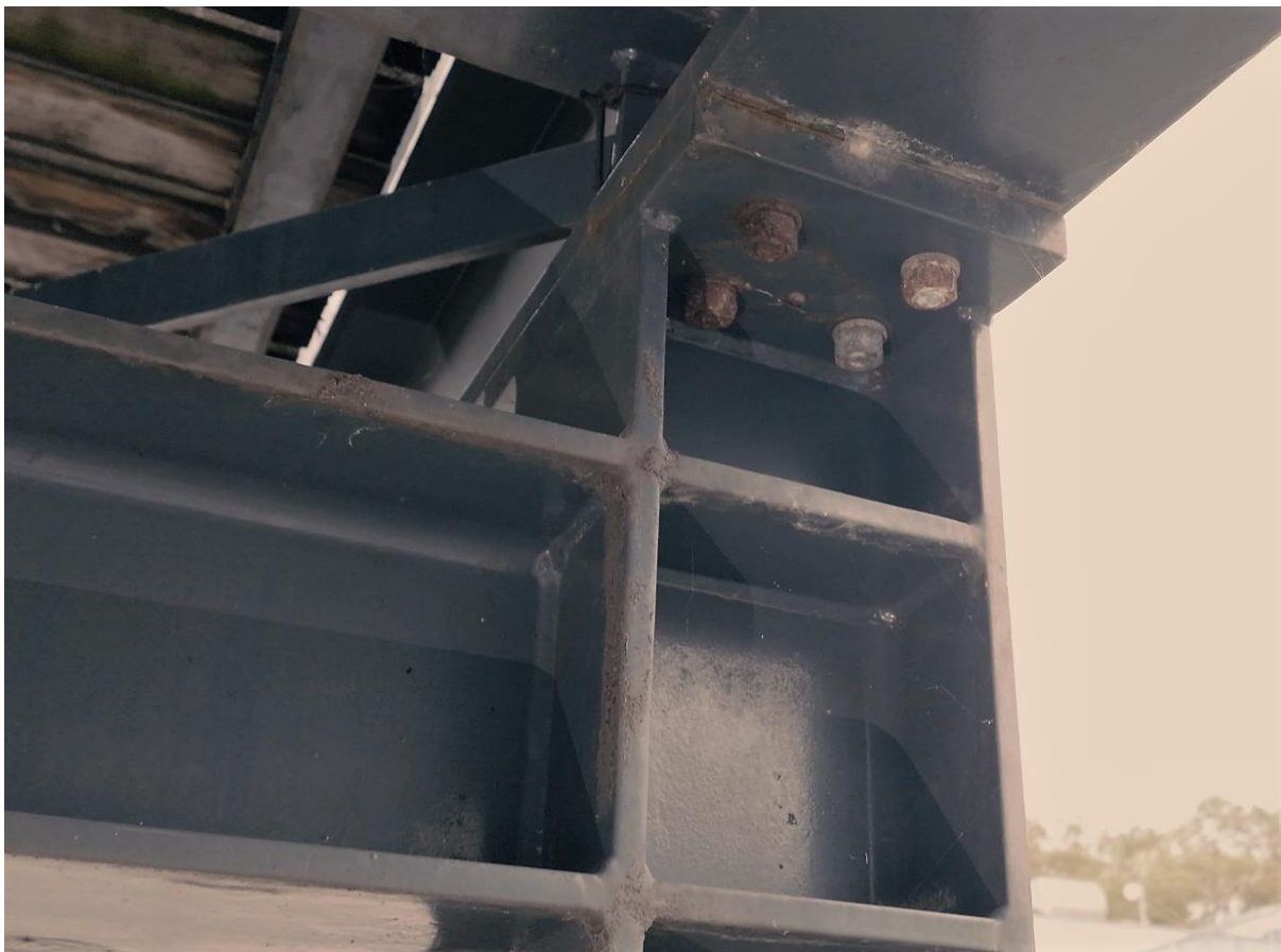
Obr.61 Pohled na uložení lávky na třetí podpěře, druhý pilíř, vlevo, krátké šrouby, otevřený styk, korozní poškození
