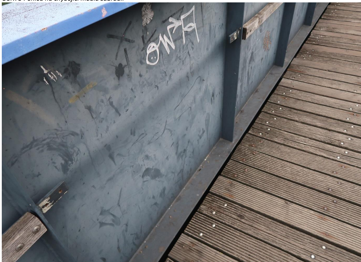
Obr.76 Pohled na chybějící madla zábradlí
