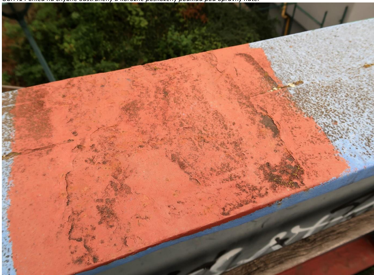
Obr.42 Pohled na chybně odstraněný a korozně poškozený podklad pod opravný nátěr
