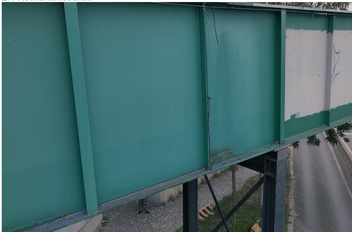
Obr.11 Pohled na odlupování nátěru na levé stěně a pásnici u KOC
