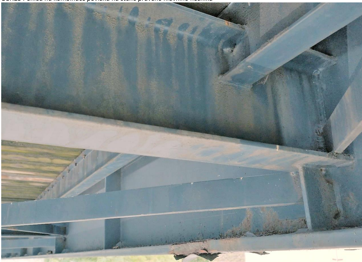
Obr.26 Pohled na zatékání do vnitřních částí lávky
