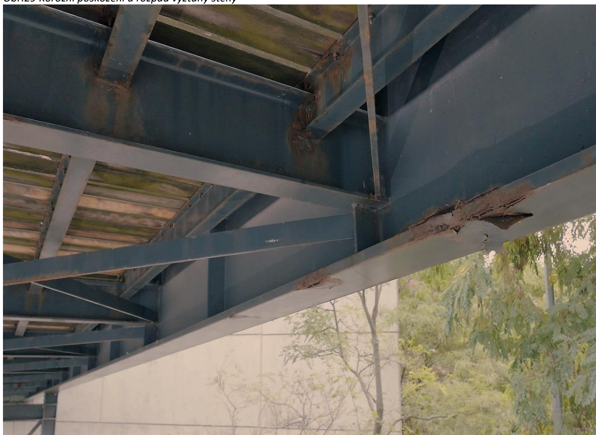
Obr.30 Odlupování nátěru a koroze ve vrstvách, pravá strana
