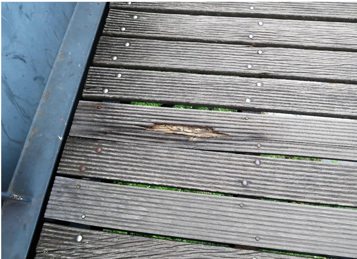
Obr.71 Pohled na vyhnílé fošny podlah
