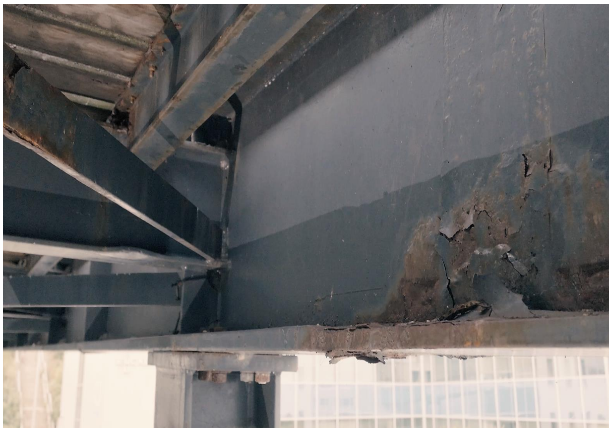
Obr.13 Pohled na levou vnitřní stěnu a korozní poškození stěny a pásnice, včetně výztuh
