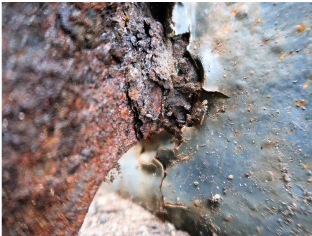
Obr.35 Detail koroze ve vrstvách ve svaru z obr.34
