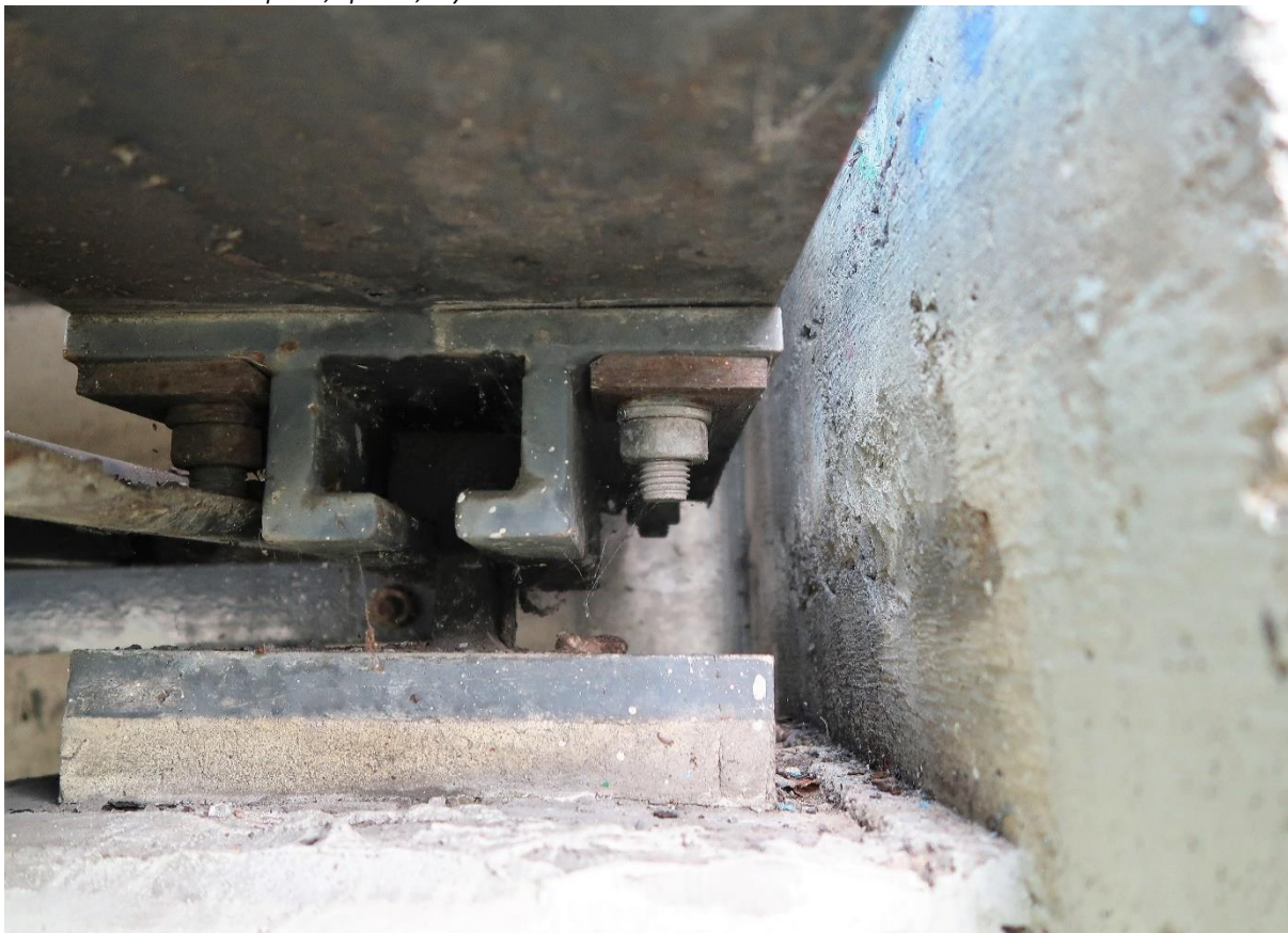
Obr.52 Pohled na ložisko levé, opěra 1, korozní poškození spojů
