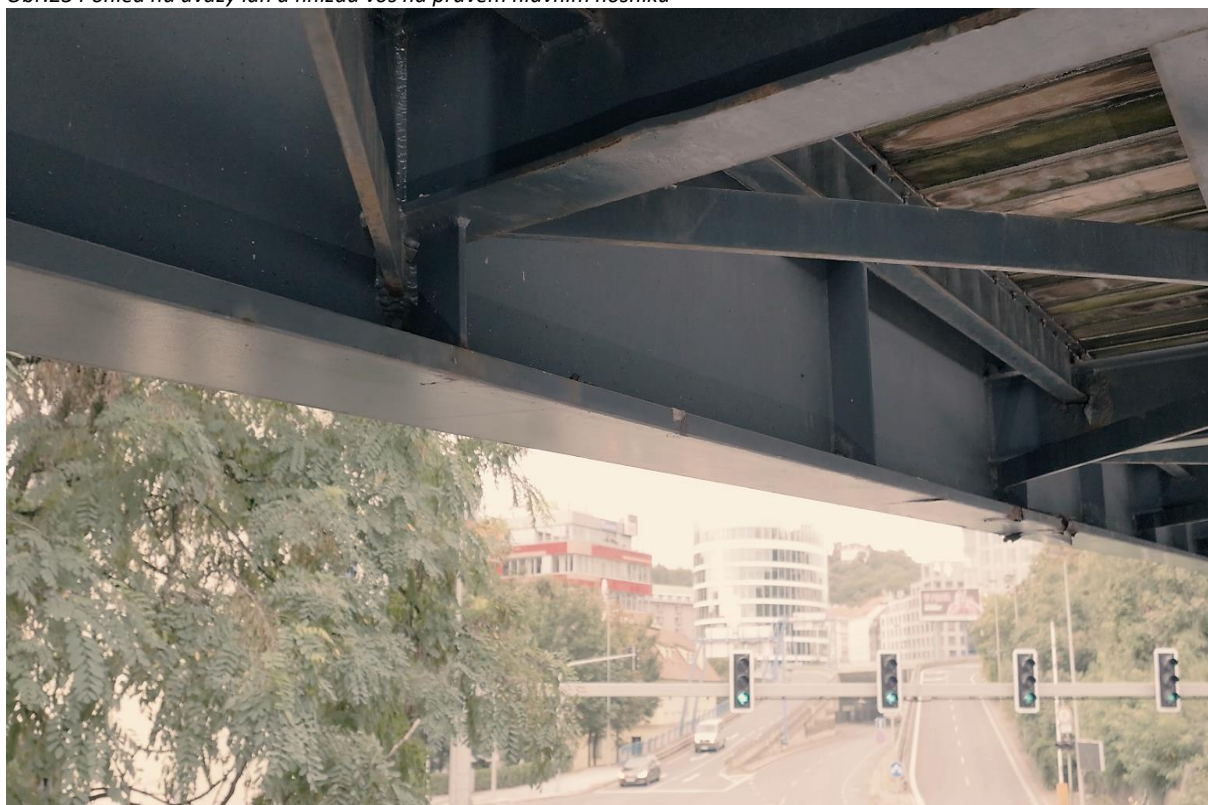
Obr.24 Pohled na korozně poškozenou dolní pásnici pravého hlavního nosníku u KOC
