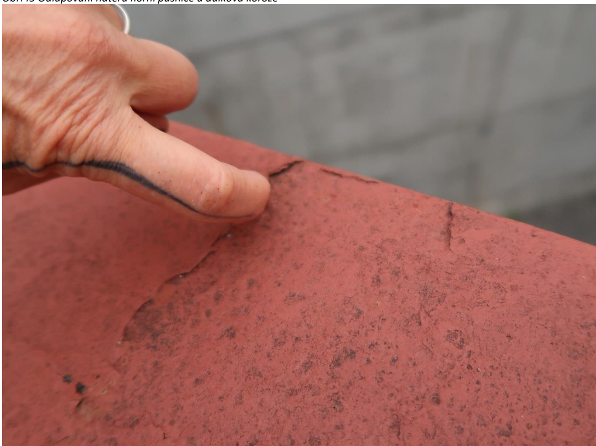
Obr.46 Pohled na chybně odstraněný a korozně poškozený podklad pod opravný nátěr
