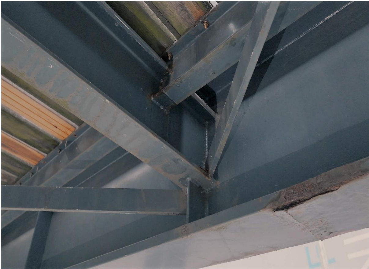
Obr.18 Pohled na levou stranu s korozním poškozením dolní pásnice
