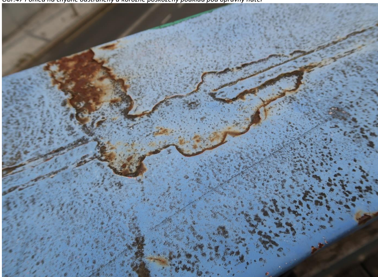
Obr.48 Pohled na chybně odstraněný a korozně poškozený podklad pod opravný nátěr
