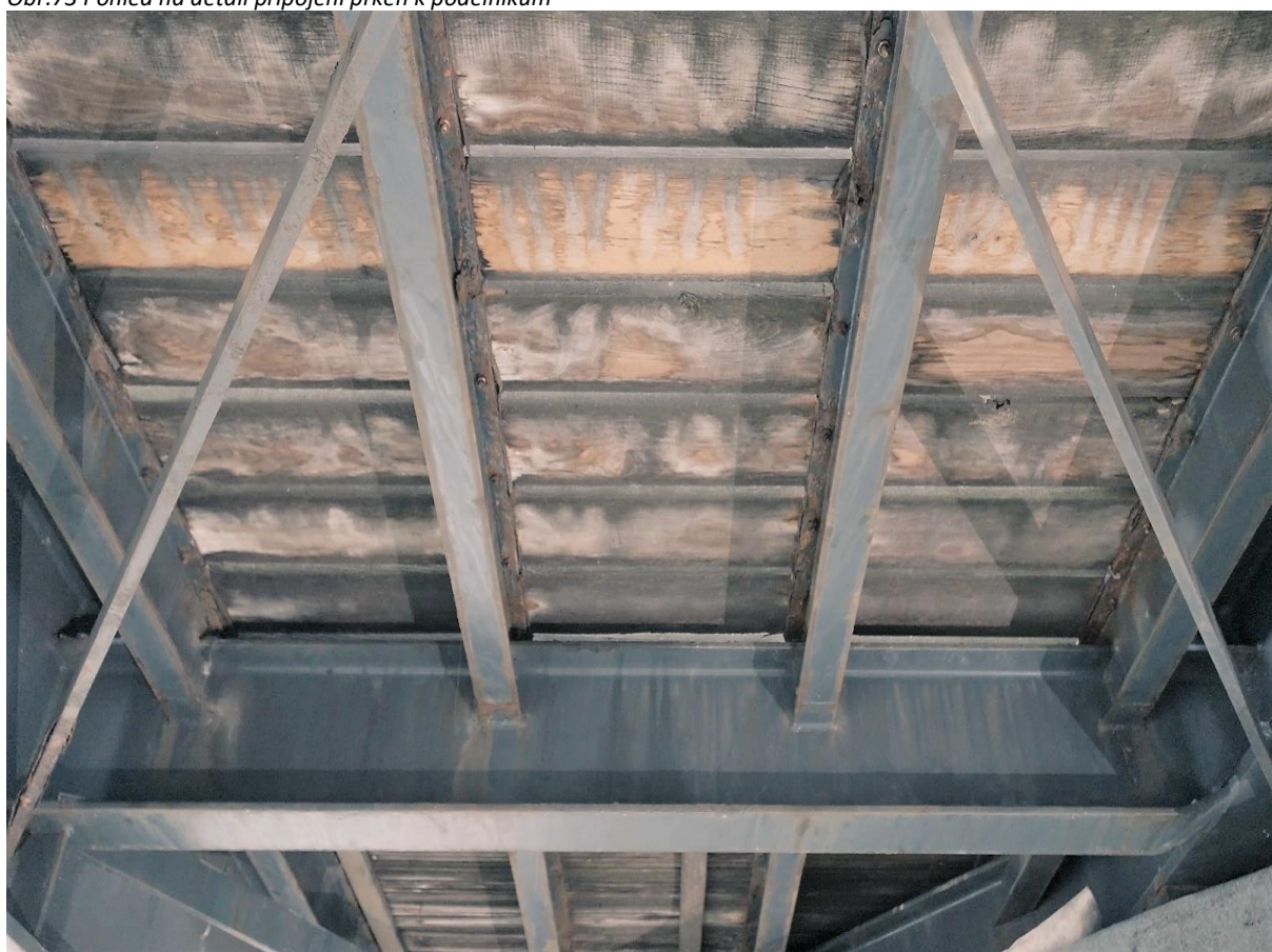
Obr.74 Pohled z dolní strany na masivní zatékání
