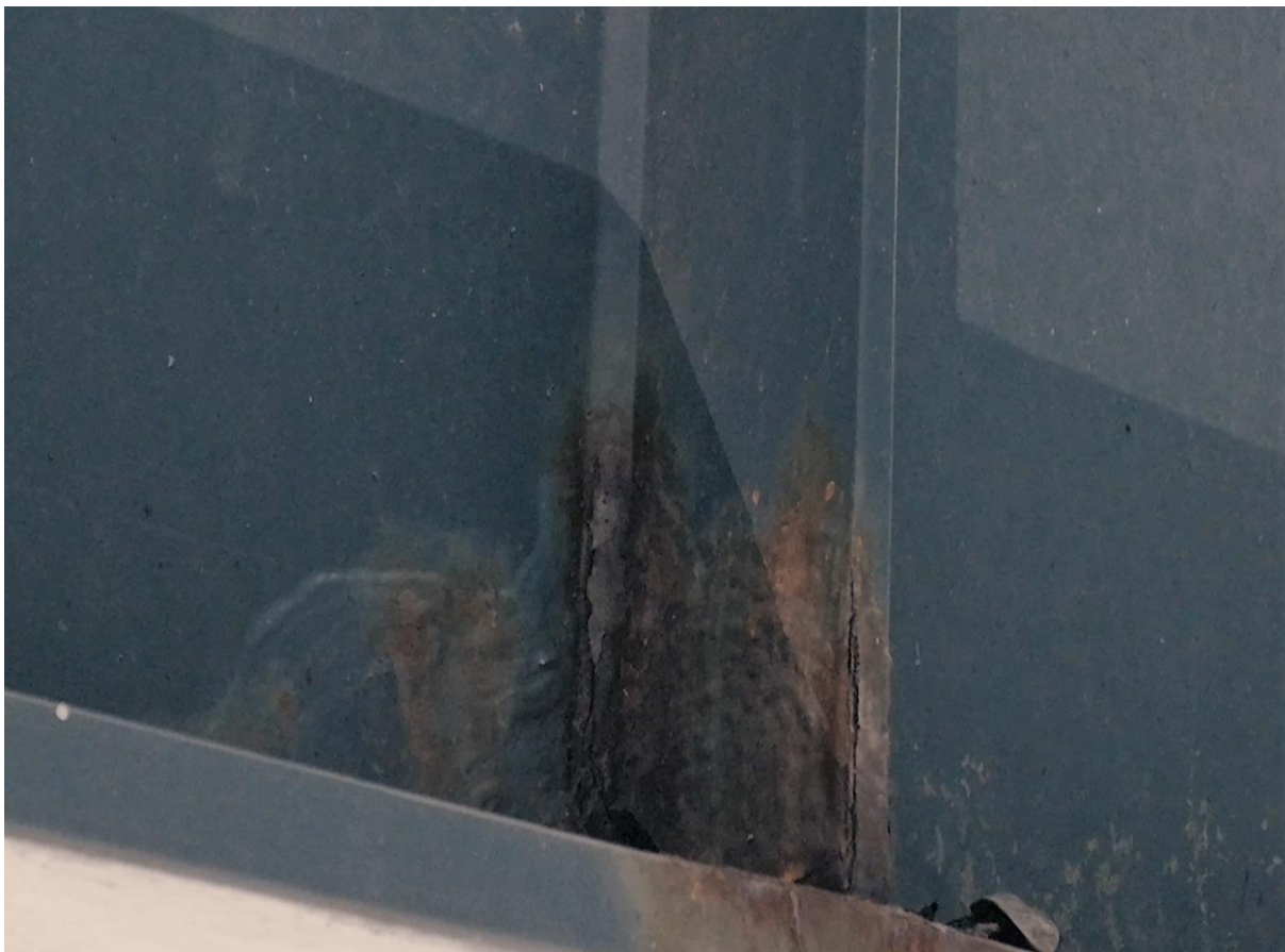
Obr.15 Pohled na korozně poškozenou výztuhu a svar stěny hlavního nosníku, levá vnitřní výztuha
