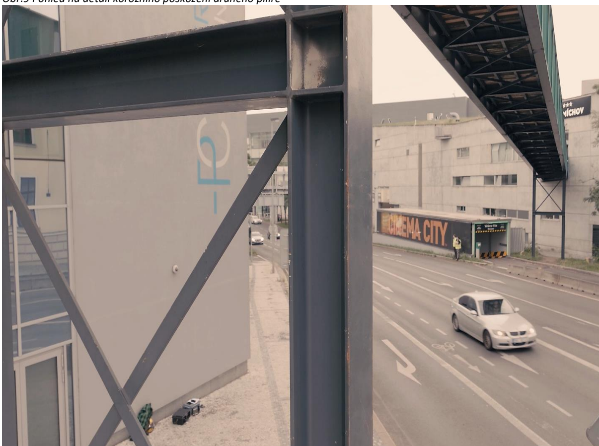
Obr.10 Pohled na korozní poškození hran prvního pilíře
