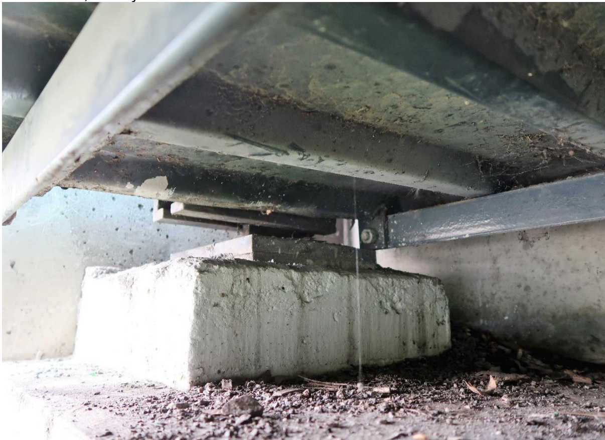
Obr.51 Pohled na ložisko pravé, opěra 1, chybí měřidla
