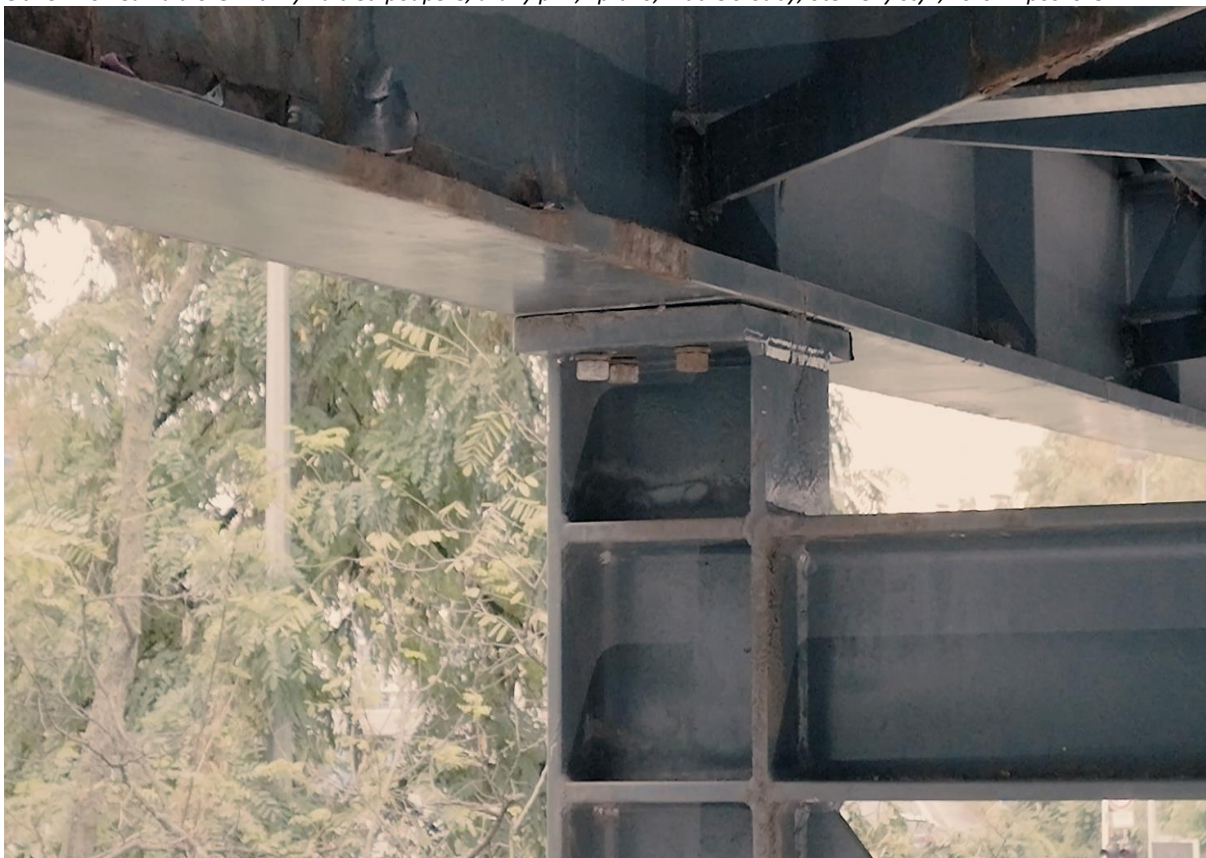
Obr.58 Pohled na uložení lávky na třetí podpěře, druhý pilíř, vpravo, krátké šrouby, otevřený kontaktní styk, korozní poškození
