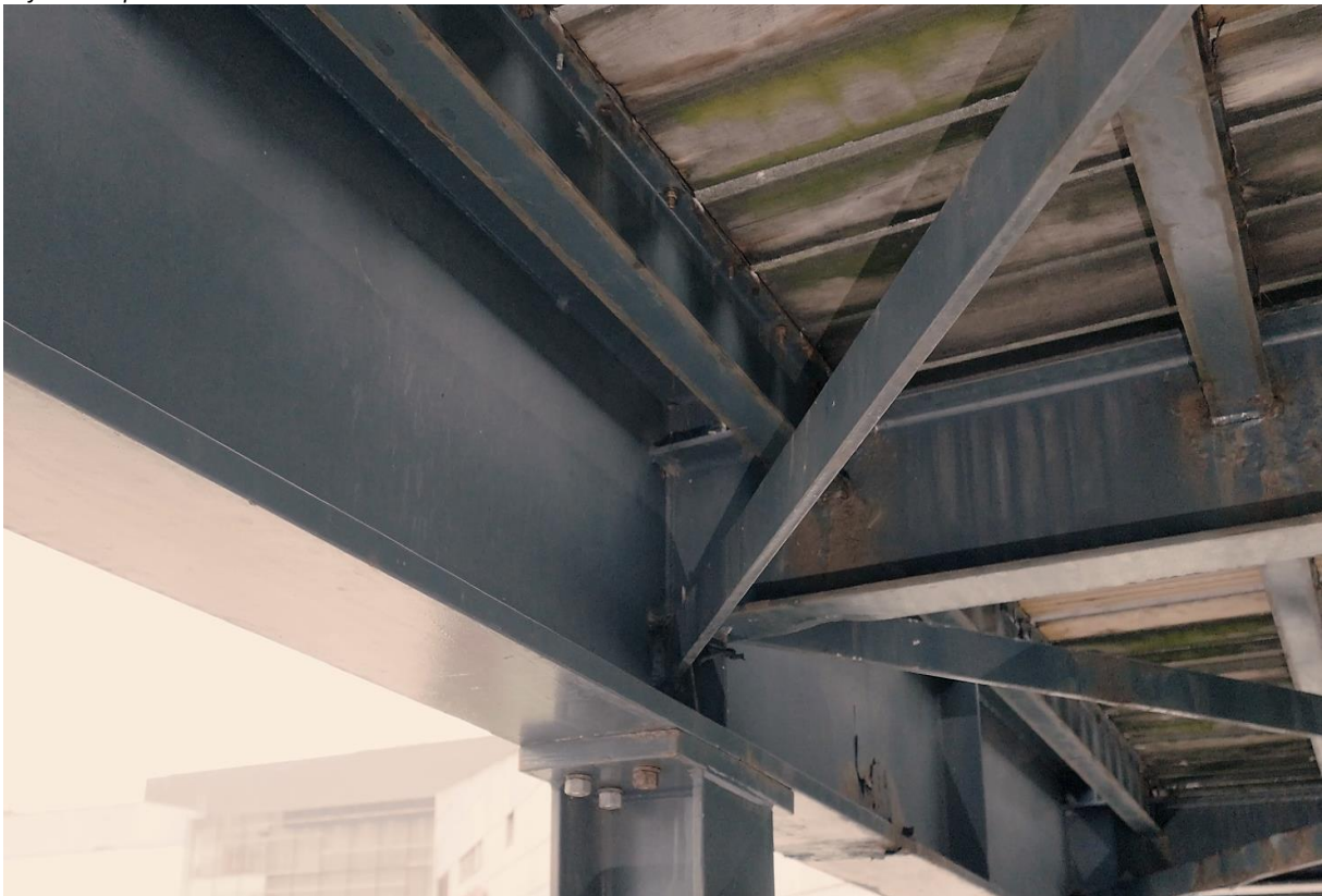
Obr.64 Pohled na uložení lávky na třetí podpěře, druhý piliř, vlevo, krátké šrouby, otevřený styk, korozní poškození a deformace příčnicku
