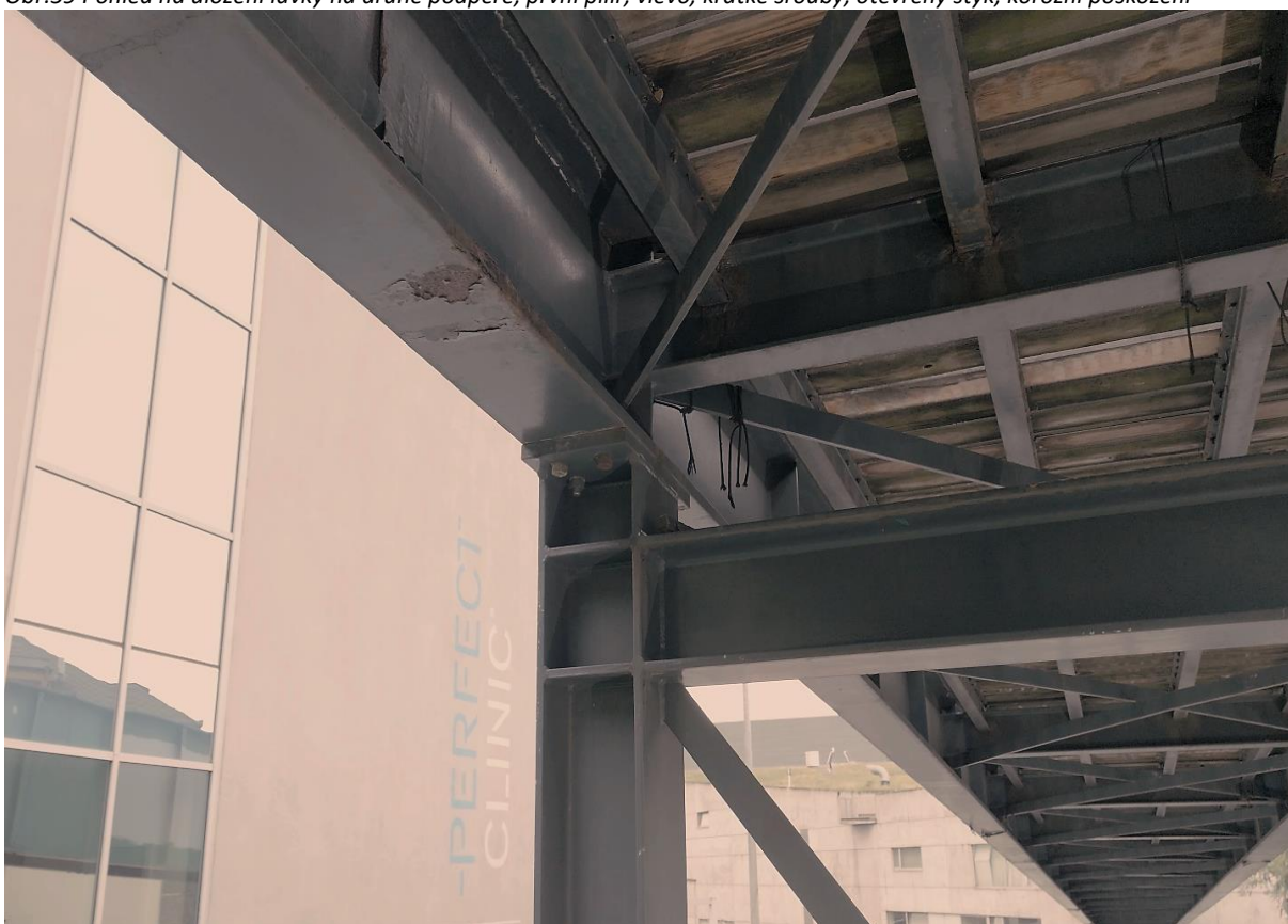
Obr.60 Pohled na uložení lávky na druhé podpěře, první pilíř, vlevo, krátké šrouby, otevřený styk, korozní poškození
