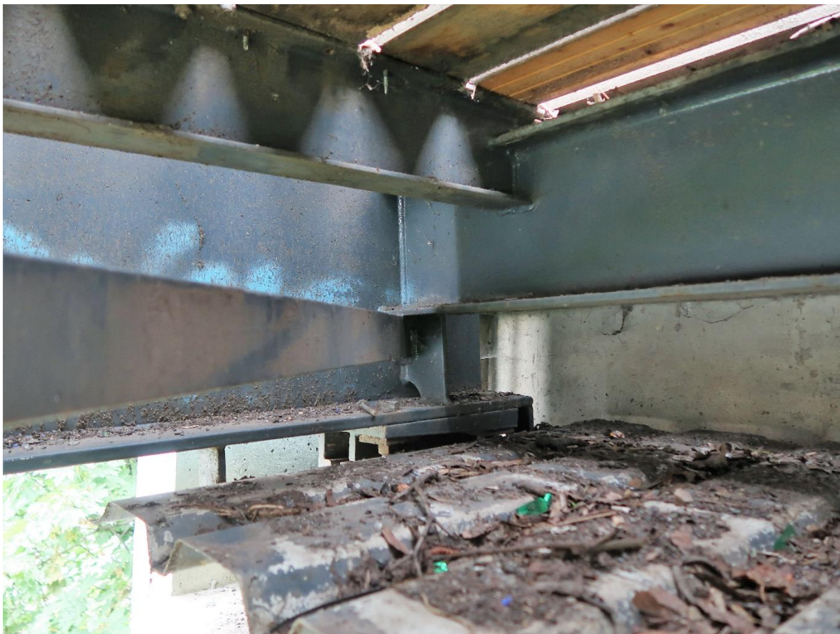
Obr.53 Pohled na znečištění dolní pásnice v místě uložení, opěra 1
