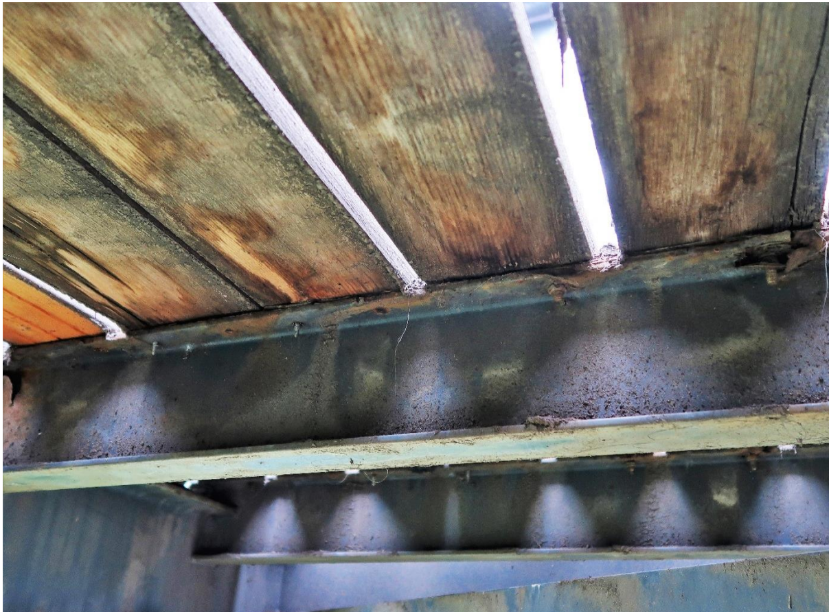
Obr.72 Pohled na zatékání z dolní strany
