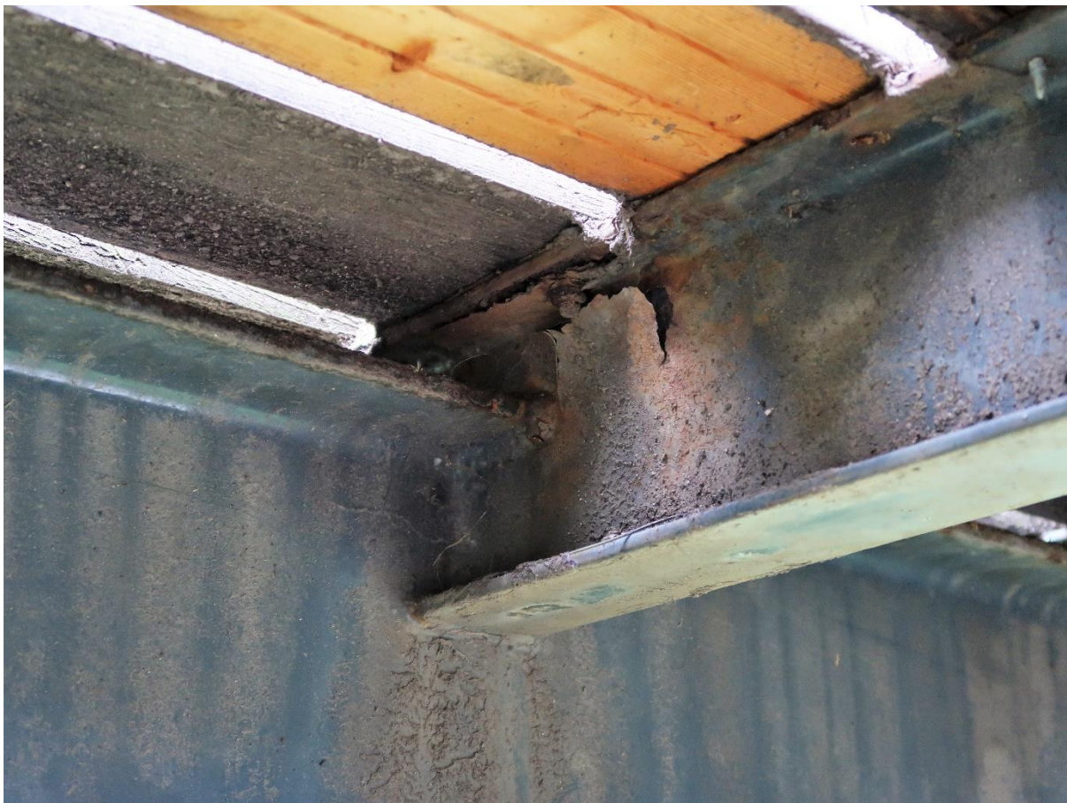
Obr. 33 detail připojení podélníku na příčník a zatékání do spojů
