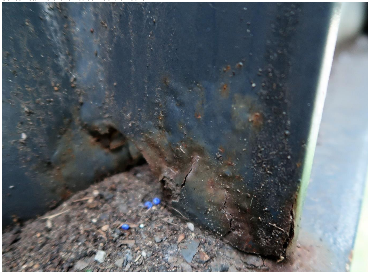
Obr.36 Korozní poškození výztuh stěny
