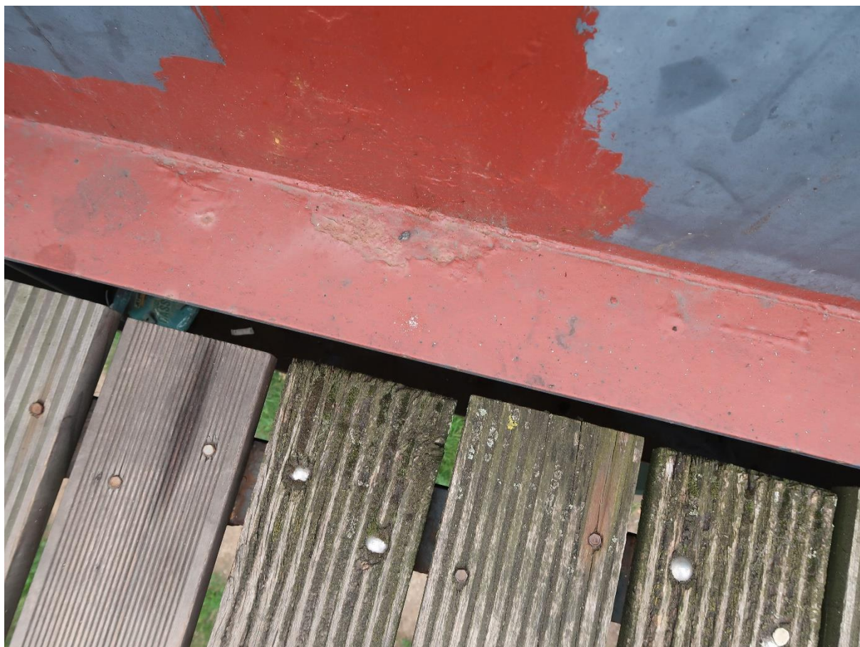
Obr.47 Pohled na chybně odstraněný a korozně poškozený podklad pod opravný nátěr
