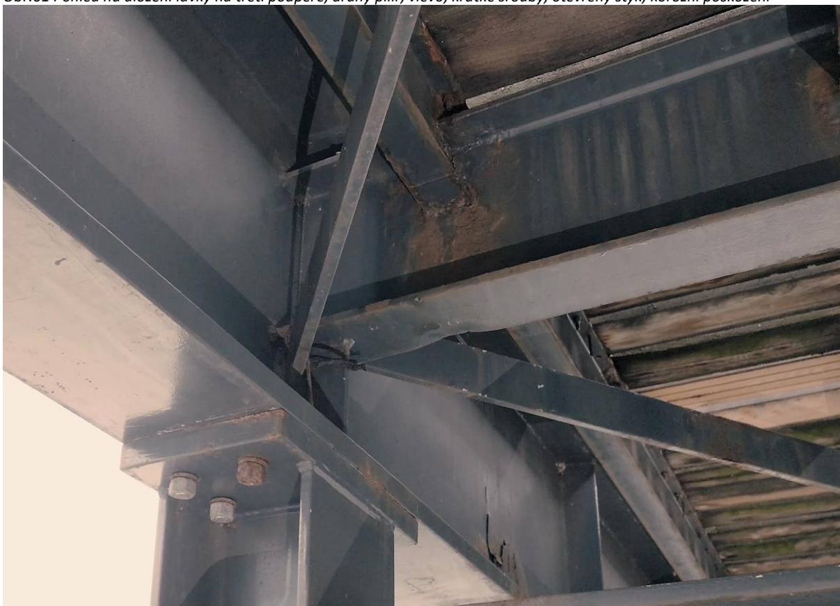
Obr.62 Pohled na uložení lávky na třetí podpěře, druhý pilíř, vlevo, krátké šrouby, otevřený styk, korozní poškození
