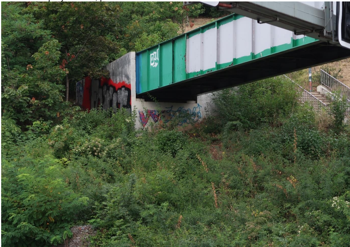
Obr.1 Pohled na opěru 1 a zarostlé neudržované svahy, graffiti na opěře a křídlech
