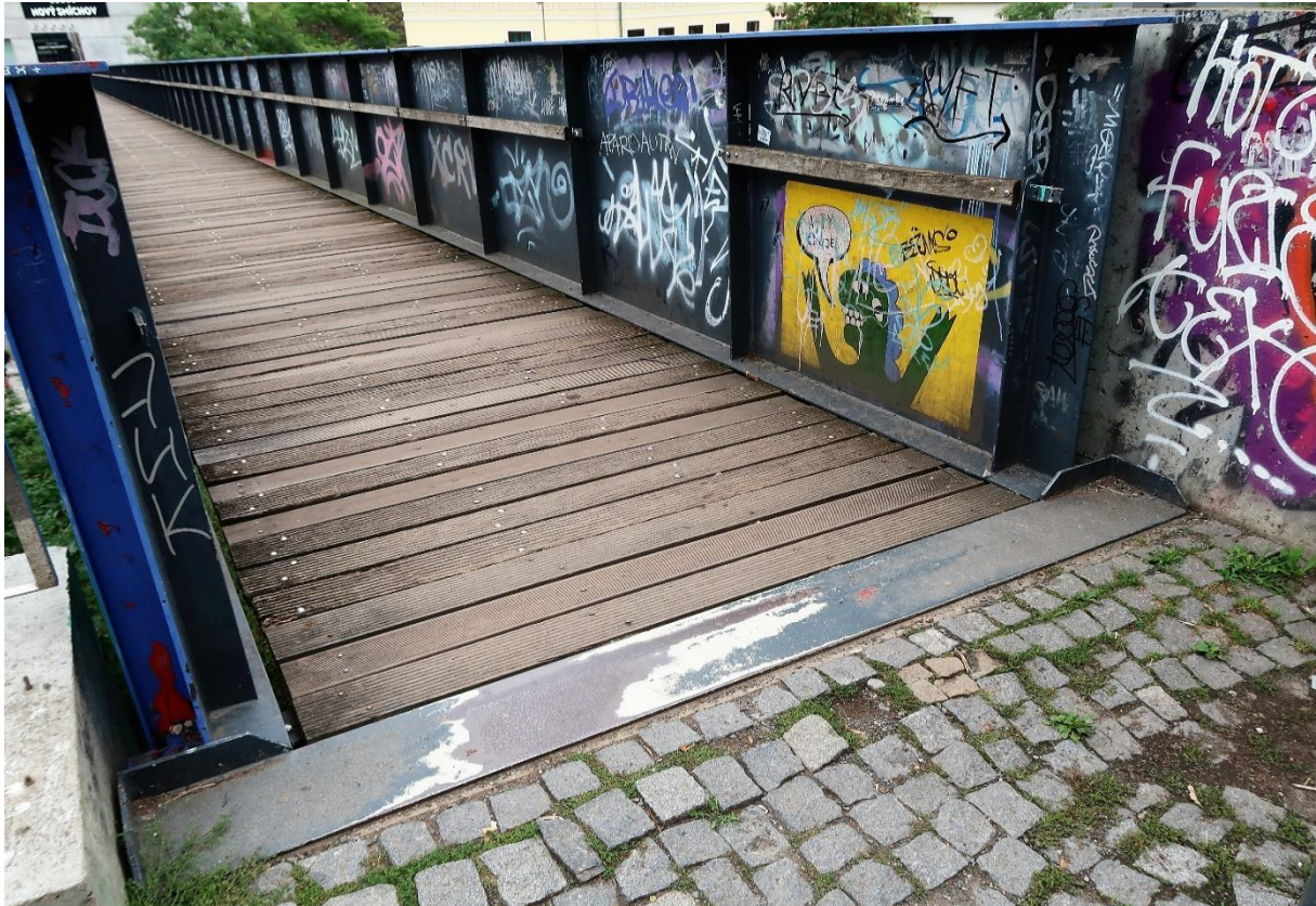
Obr.66 Pohled na hladký plech mostního závěru, který měl být protiskluzový
