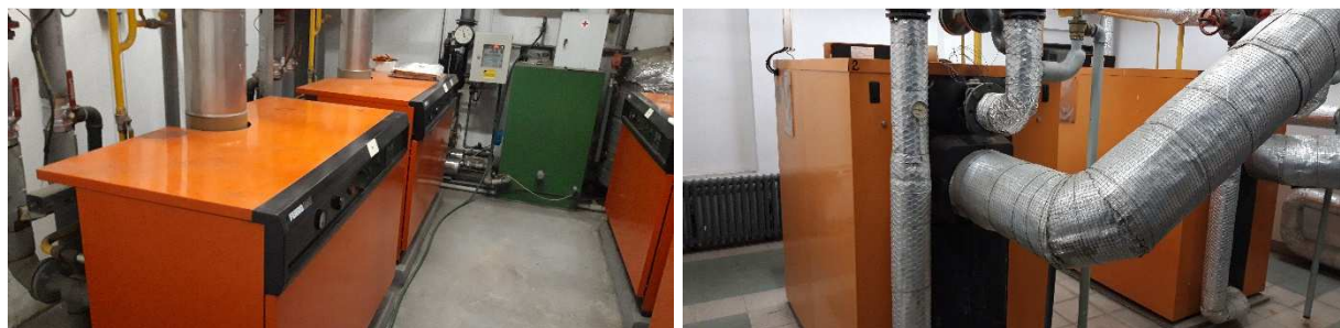
Obrázek 3: Kotelna pro objekty Štefánikova 13 a 15, kotelna pro objekty 14.října 4 a Preslova 4
