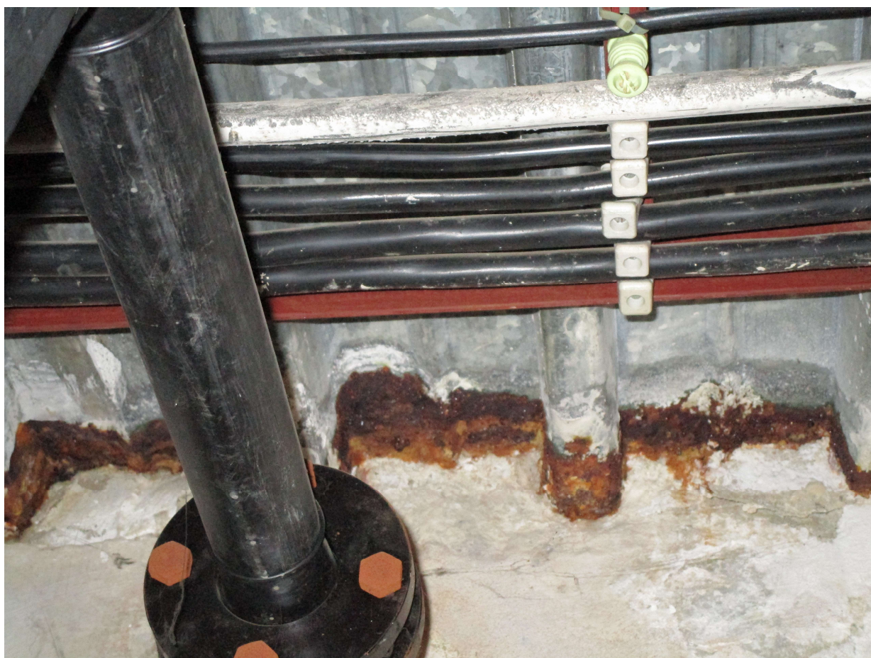
Foto č. 0.39 – 1.PP – masivní koroze trapézových plechů na spodním líci stropu
