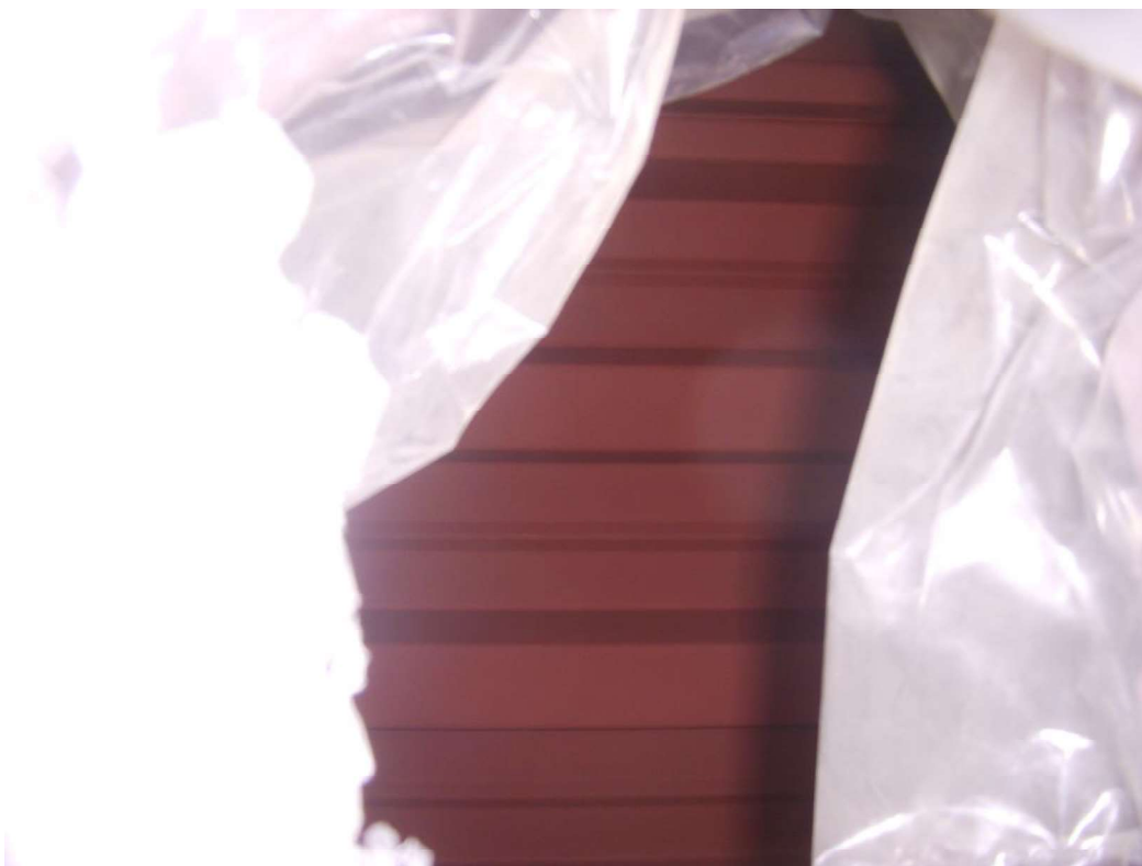
11...detail trapézového plechu zkoumaného endoskopem – místo 5
