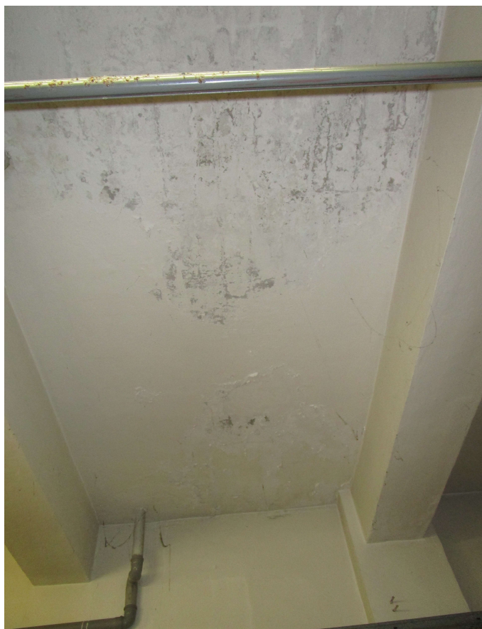
Foto č. 0.73 – 1.PP – stopy dřívějšího zatékání do stropu z 1.NP
