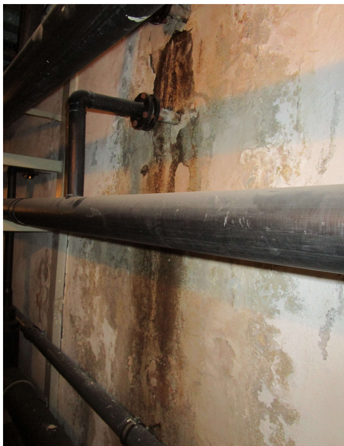
Foto č. 0.38 – 1.PP – plošné průsaky vody žb.stěnou bazénu
