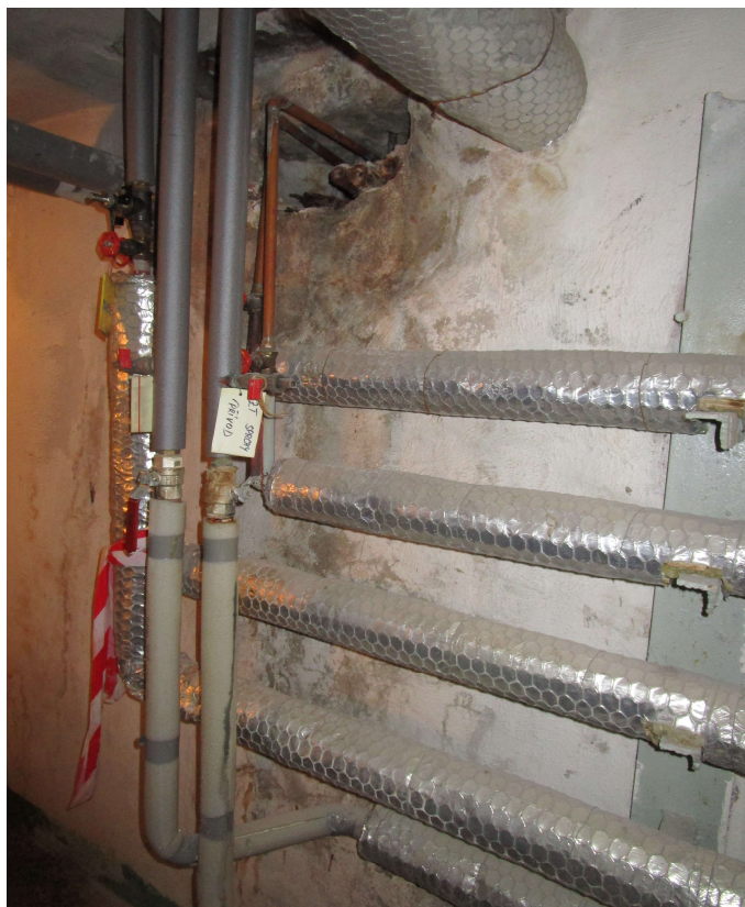
Foto č. 0.13 - 1.PP – průsaky vody do konstrukce suterénní stěny
