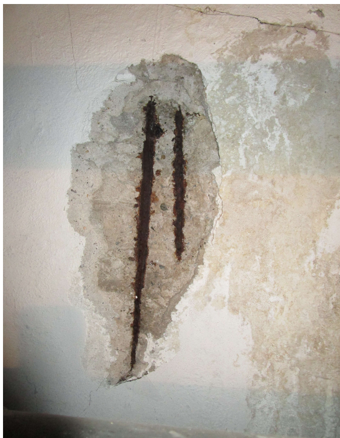
Foto č. 0.45 – 1.PP – odprýsknutí krycí vrstvy betonu a koroze výztuže stěny bazénu
