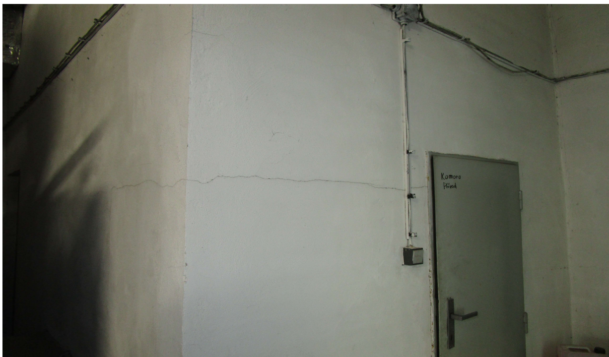
Foto č. 1.22 – 1.NP – vodorovná trhlinka šířky cca 1 mm v příčce strojovny VZT
