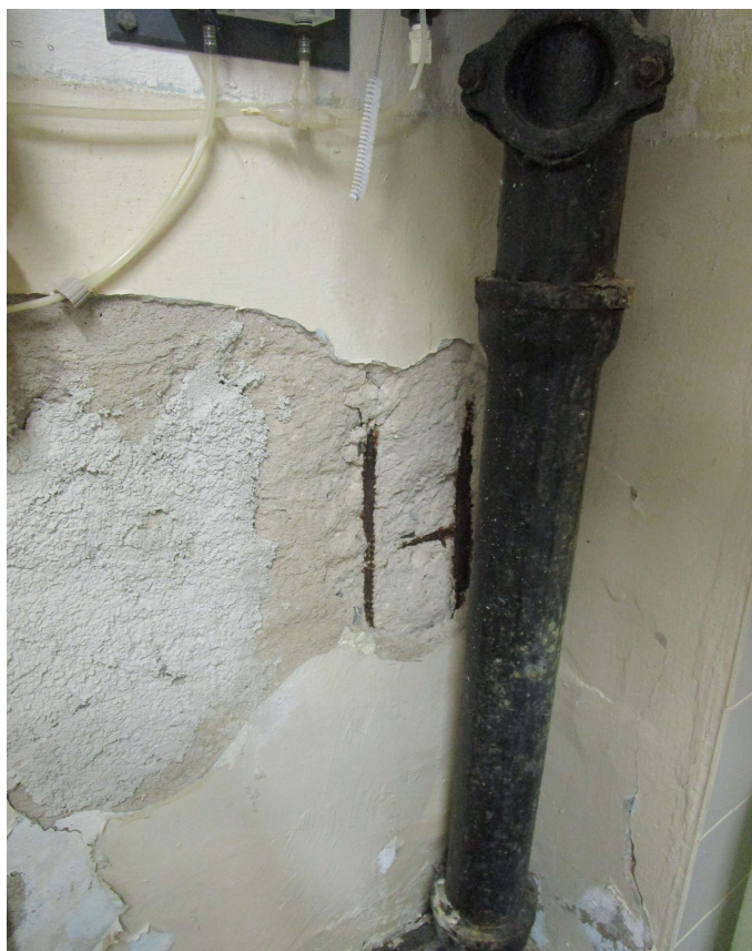
Foto č. 0.120 – 1.PP – koroze výztuže obvodové suterénní železobetonové stěny
