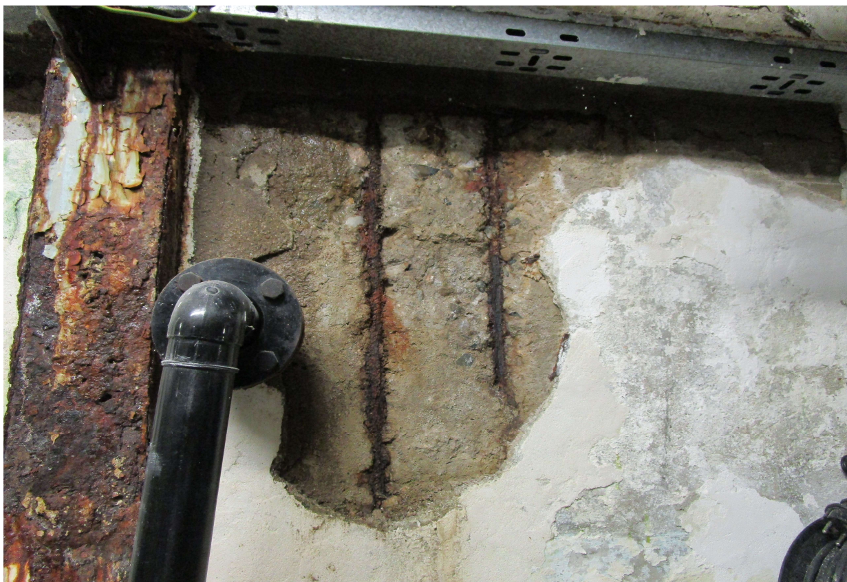
Foto č. 0.89 – 1.PP – koroze ocelových prvků vlivem zatékání, odprýsknutí krycí vrstvy betonu a koroze výztužných vložek stěny akumul.jímky
