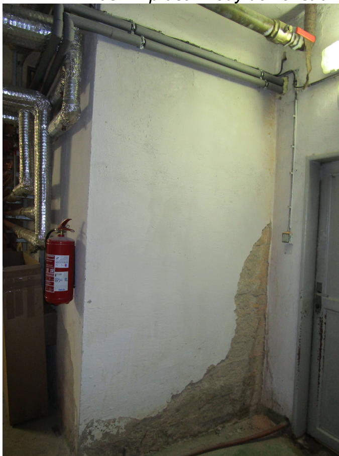
Foto č. 0.06 - 1.PP – průsak vody do konstrukce suterénní stěny
