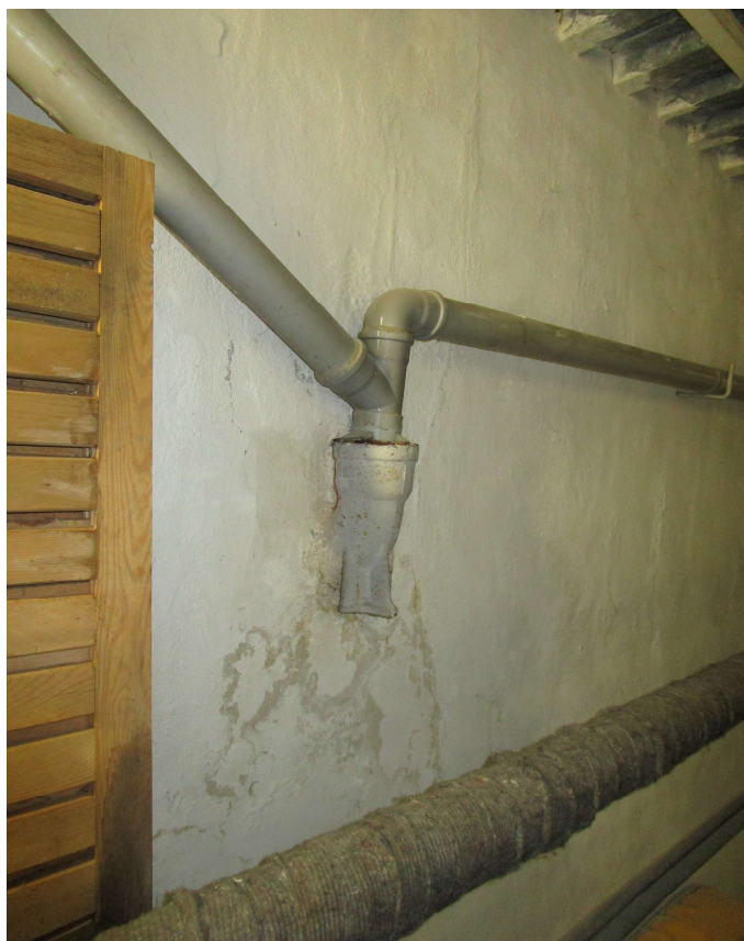
Foto č. 0.107 – 1.PP – průsaky a zatékání suterénní obvodovou stěnou
