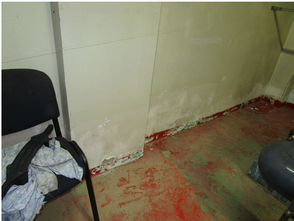
Foto č. 0.66 – 1.PP – vzlínání vlhkosti do obvodové suterénní stěny
