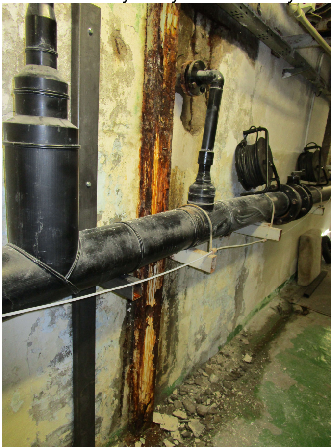
Foto č. 0.91 – 1.PP – průsak vody dilatací mezi bazénem a akumul.ační jímkou, koroze a odlupování krycích vrstev
