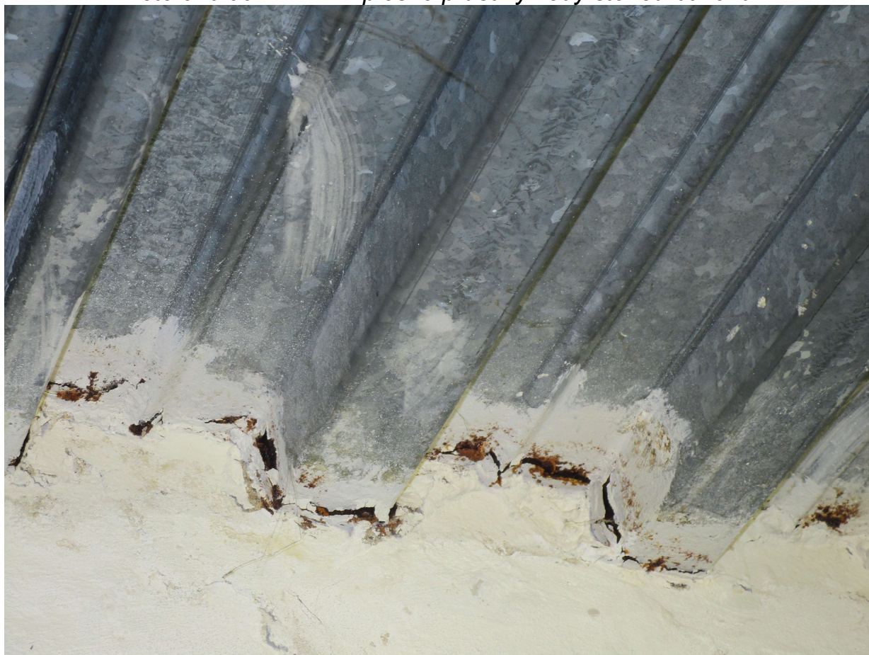
Foto č. 0.103 – 1.PP – koroze trapézových plechů na spodním líci stropu
