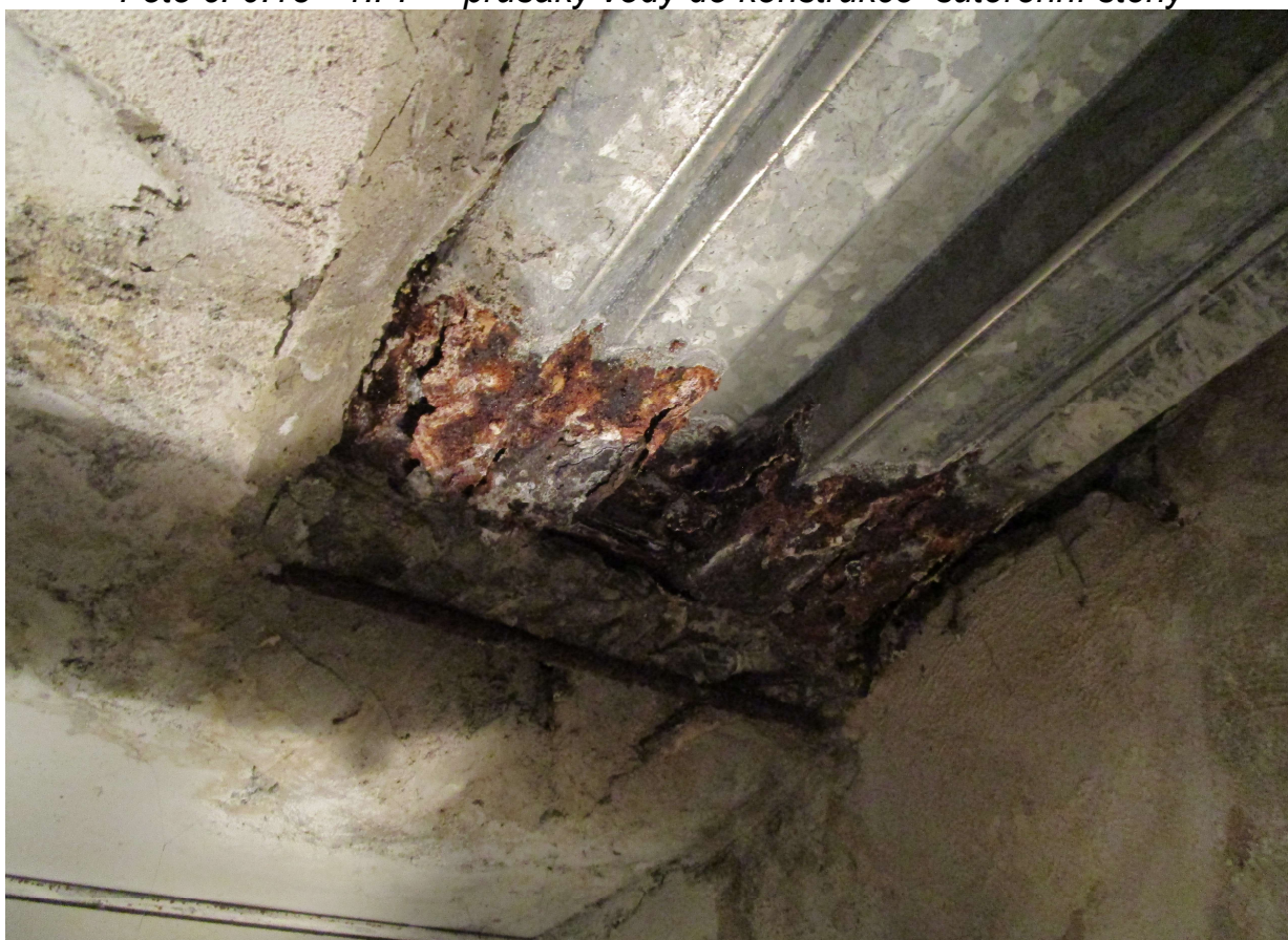
Foto č. 0.15 – 1.PP – totální koroze trapézových plechů na spodním líci stropu
