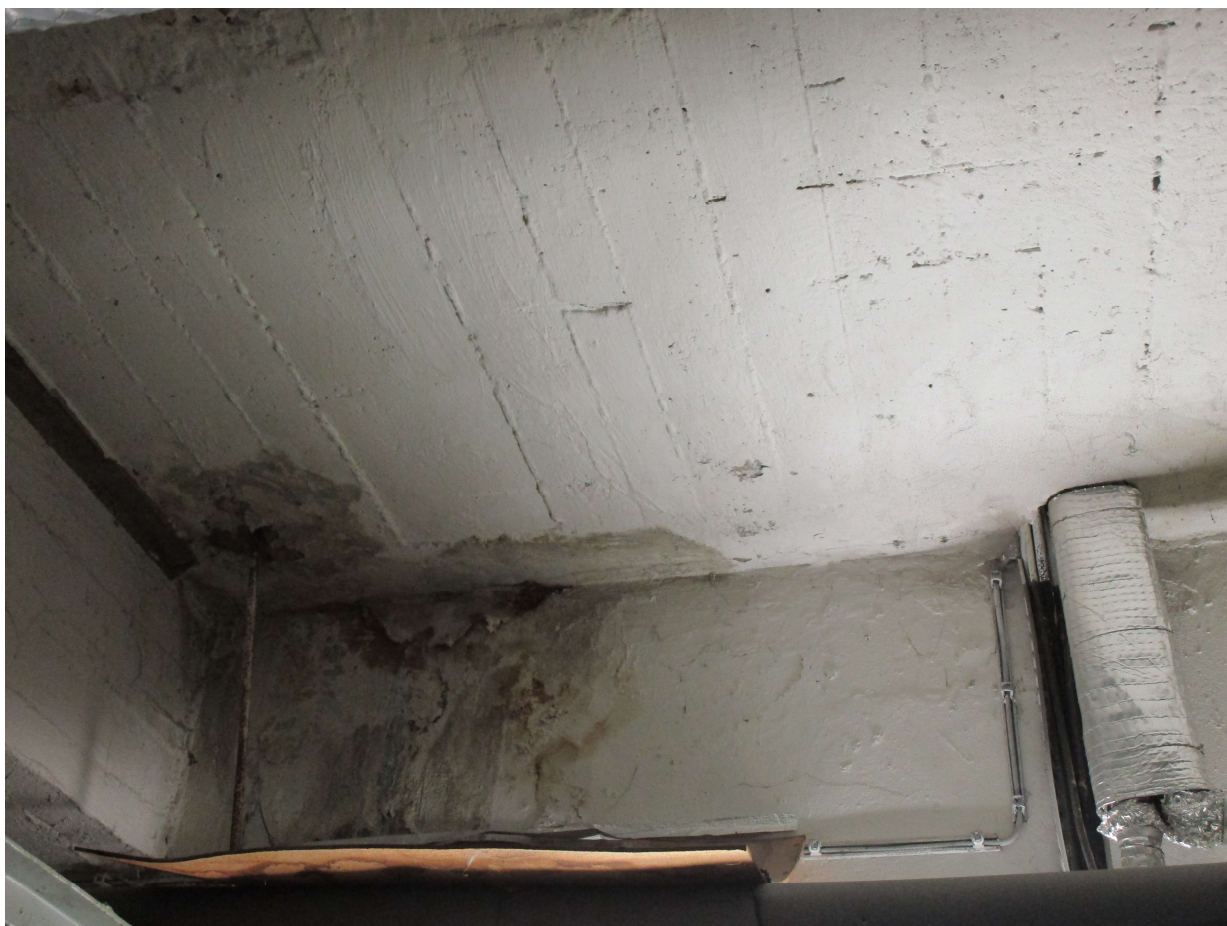
Foto č. 0.21 – 1.PP – průsaky vody obvodovou suterénní stěnou
