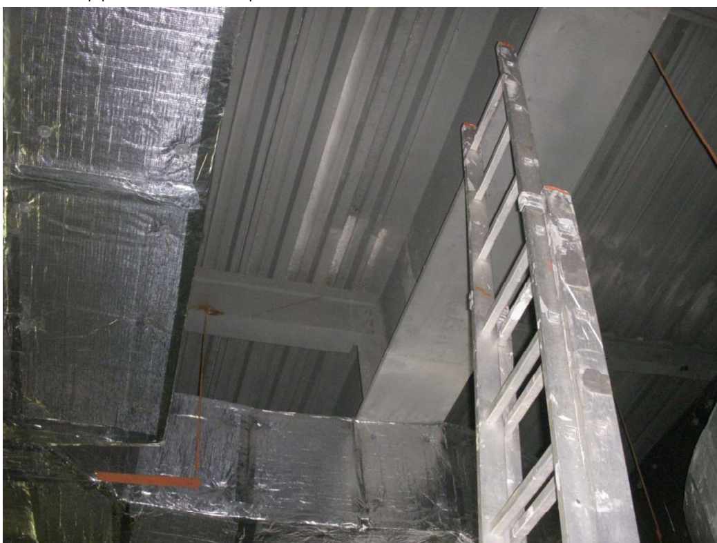
2...zastropení v místě sondy 1, kde není proveden podhled
