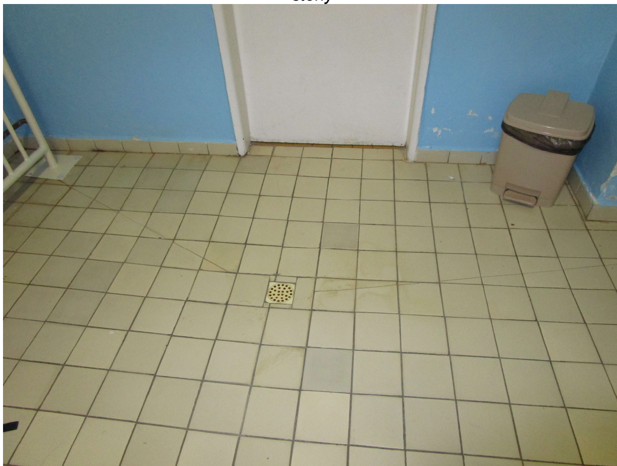
Foto č. 1.03 – 1.NP – vlasové trhliny v dlažbě podlahy v šatně
