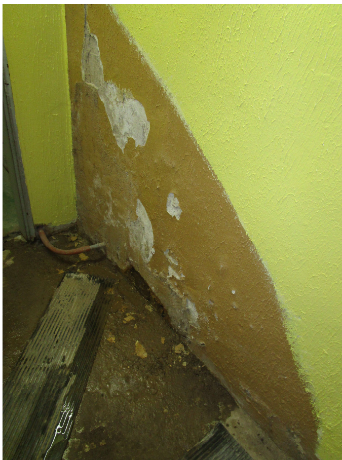
Foto č. 0.02 – 1.PP – masivní průsak vody do konstrukce sut.stěny
