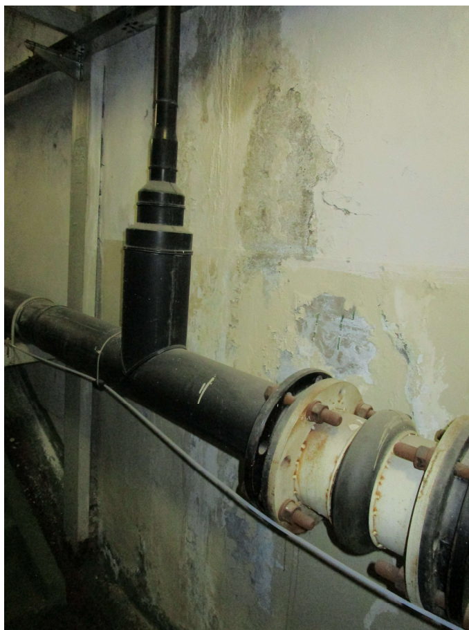
Foto č. 0.99 – 1.PP – plošné průsaky vody stěnou bazénu
