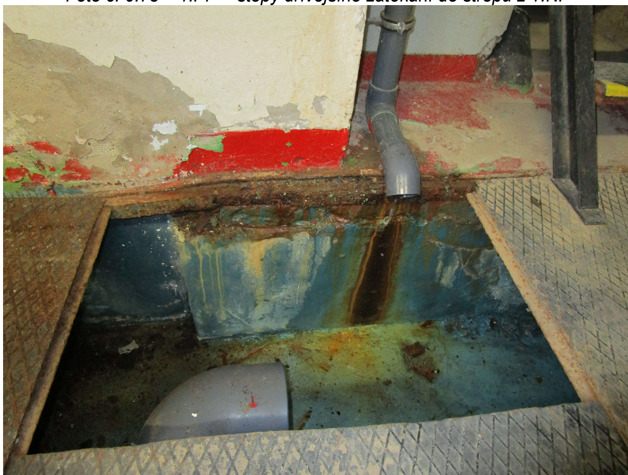
Foto č. 0.80 – 1.PP – totální koroze kování podlahových kanálů
