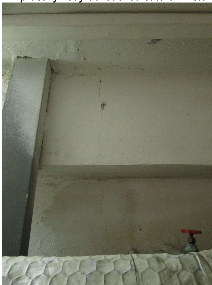
Foto č. 0.27 – 1.PP – svislá vlasová trhлина v omítce suterénní stěny
