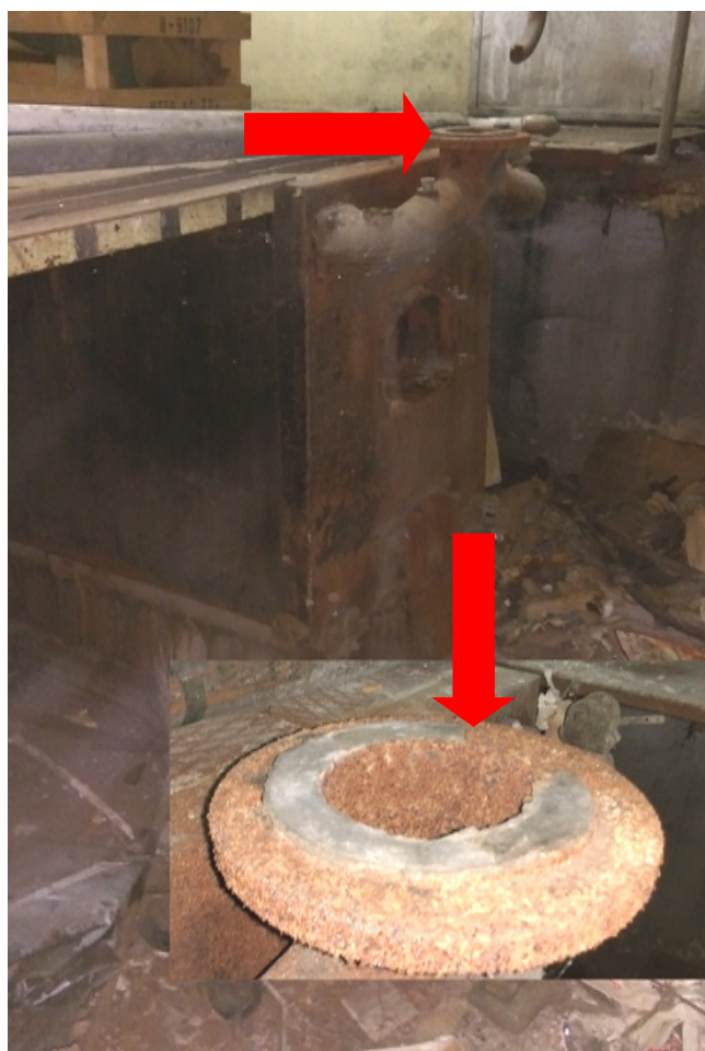
Obr. 2. 1.Pp, kotelna, azbestové ploché těsnění v demontované přírubě tlakového potrubí.
