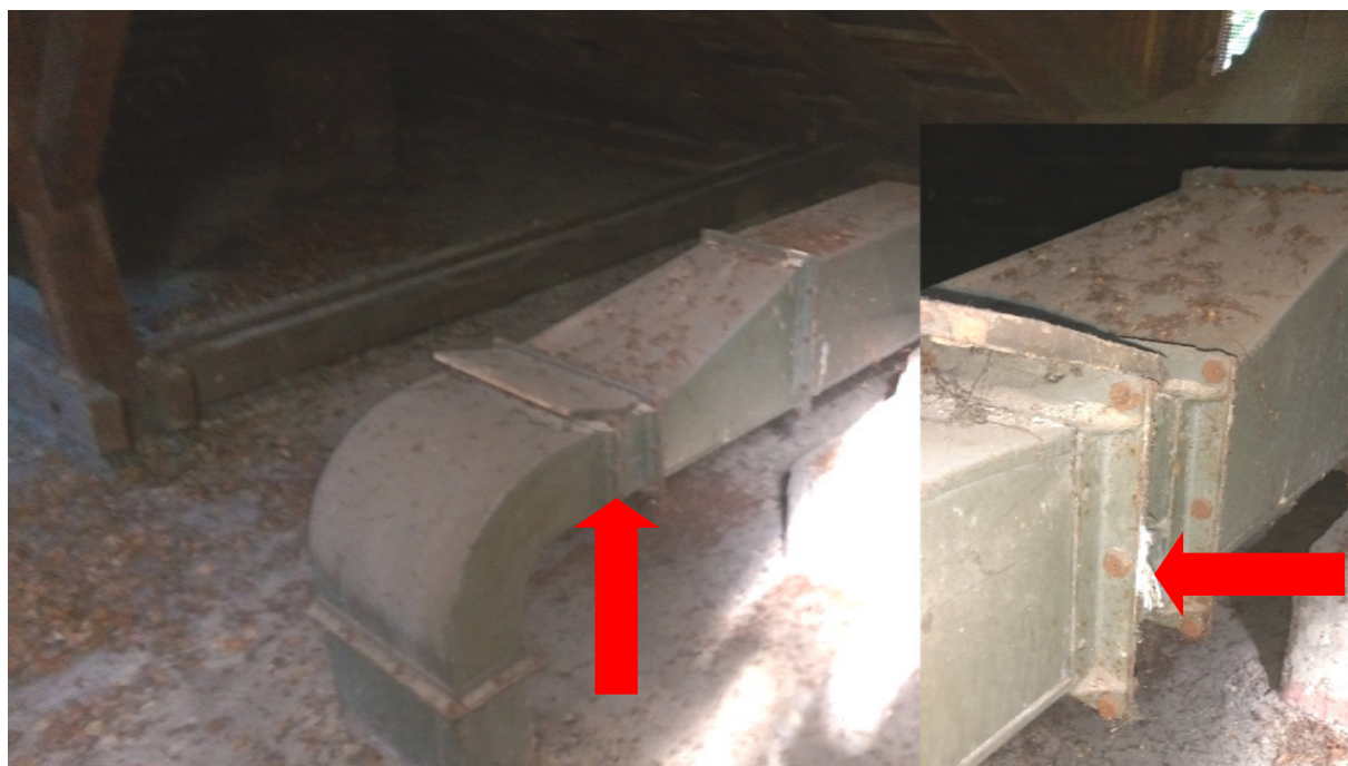
Obr. 1. Půda, rozvod VZT, azbestová těsnící šňůra v přírubovém spoji rozvodového potrubí.
