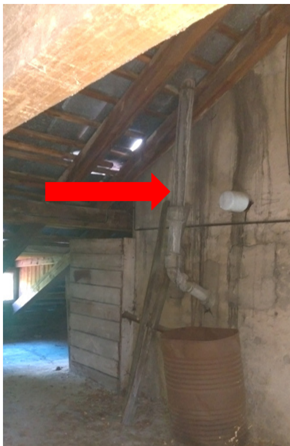
Obr. 4. Azbestocementová roura zaústěná do komína.
