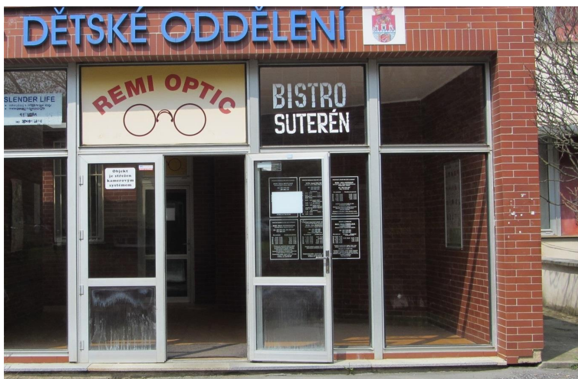
Povětrností narušovaná východní fasáda:
