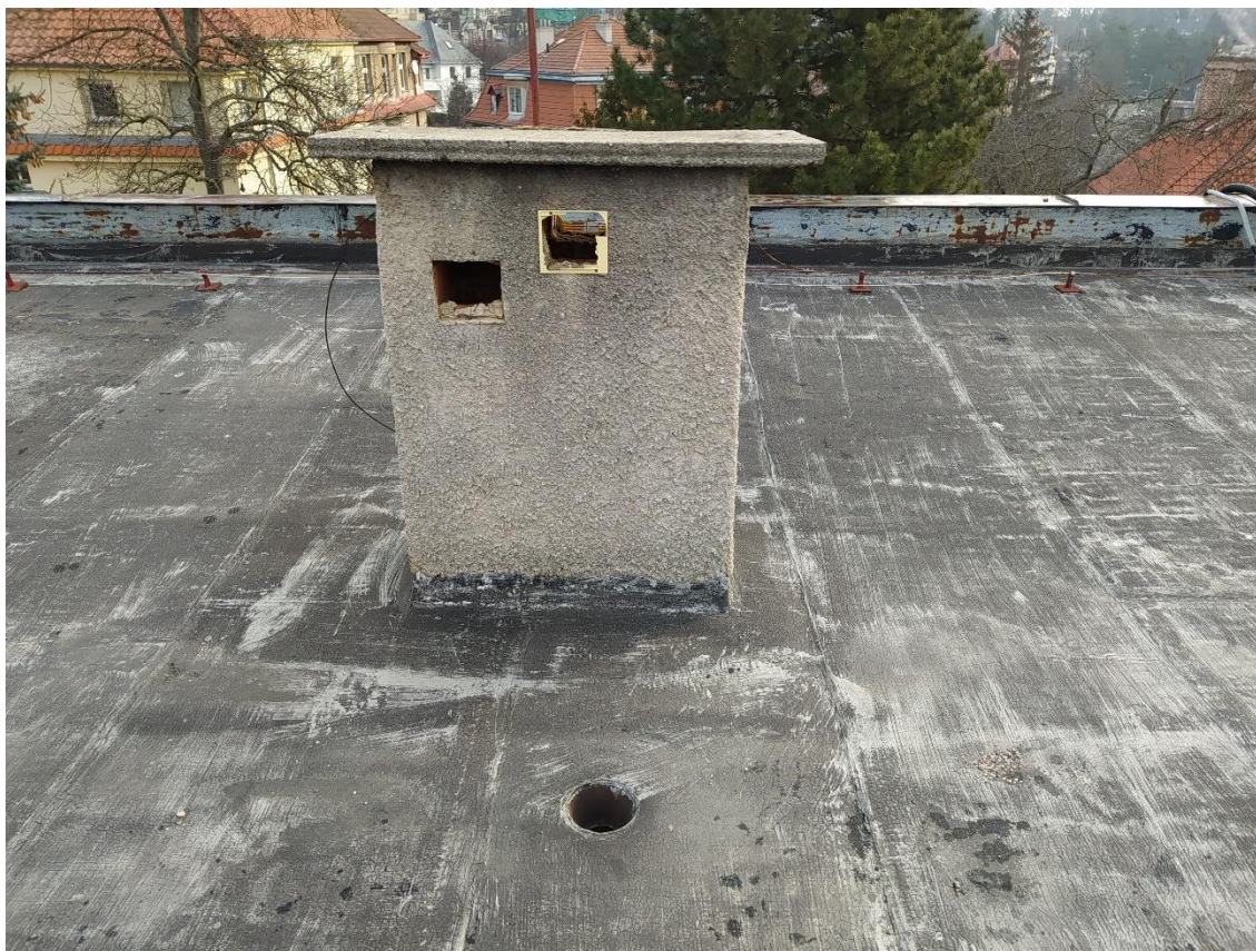
Stav střešních komínků
