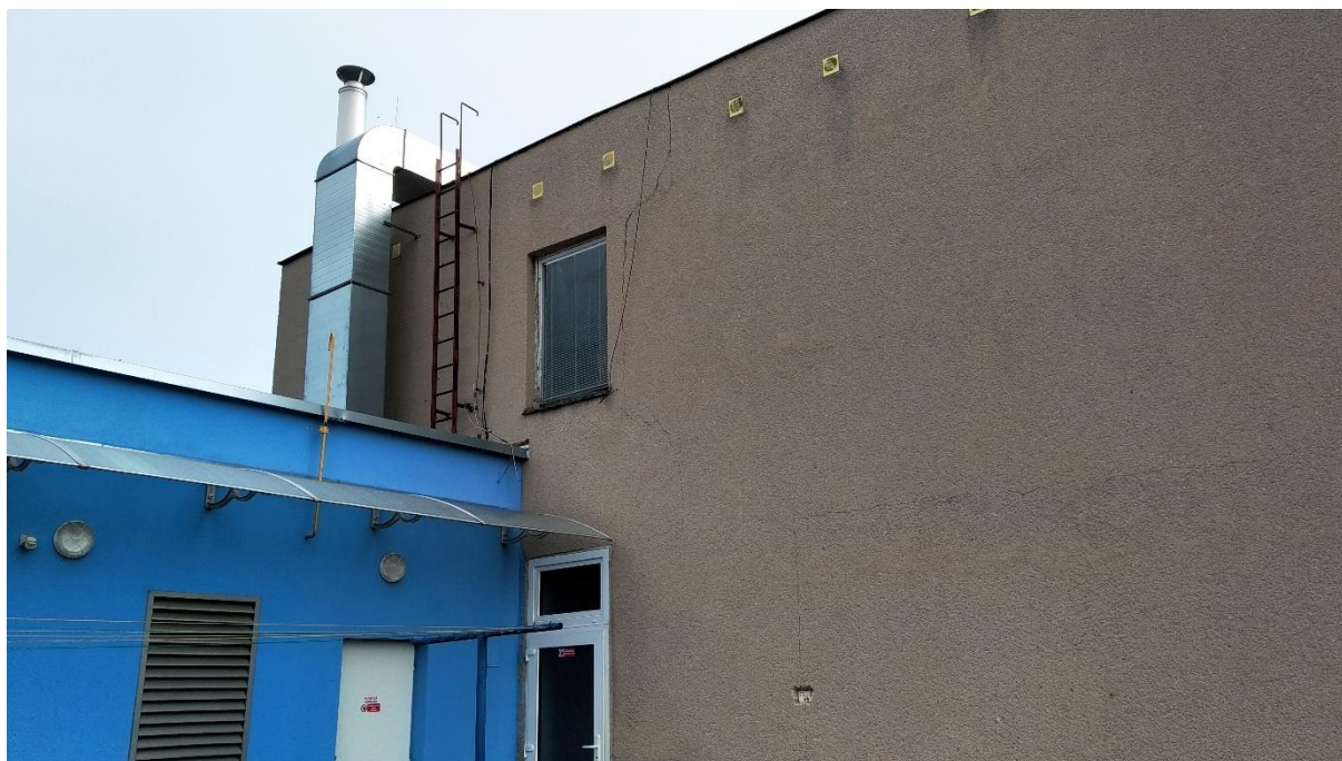
Obrázek 5 – Popraskaná nezateplená část objektu:
