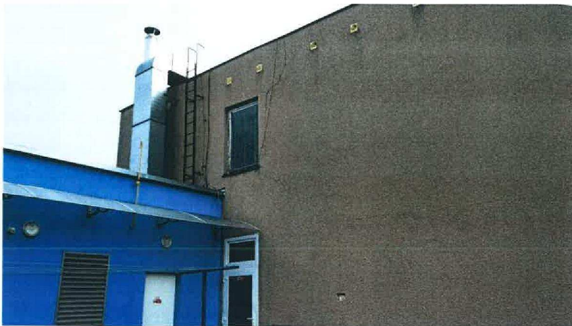
Obrázek 5 – Popraskaná nezateplená část objektu:
